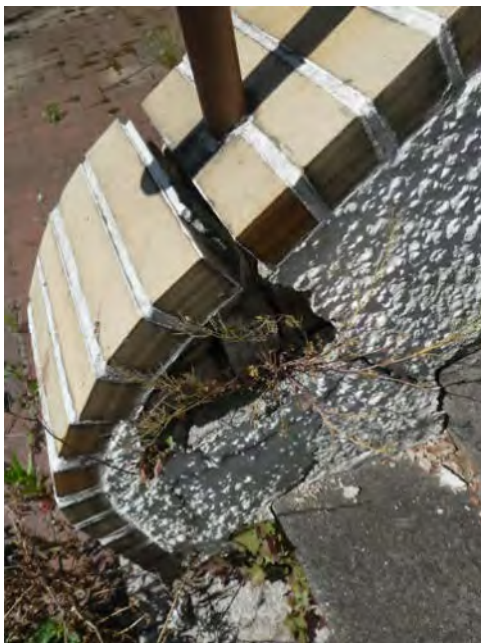
Bild 67: Treppe Veranda rückwärtig Rissbildung
