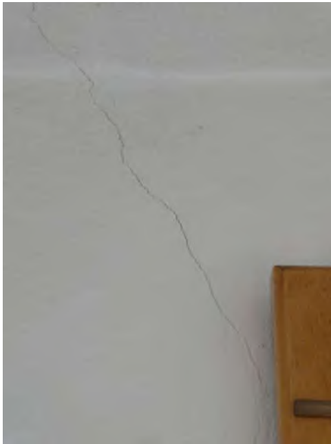
Bild 21: EG Veranda Rissbildung
