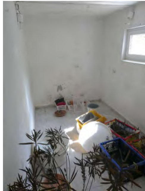
Bild 62: Keller (unterhalb Veranda)
