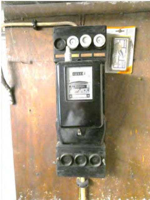
Bild 49: KG Situation Elektrik
