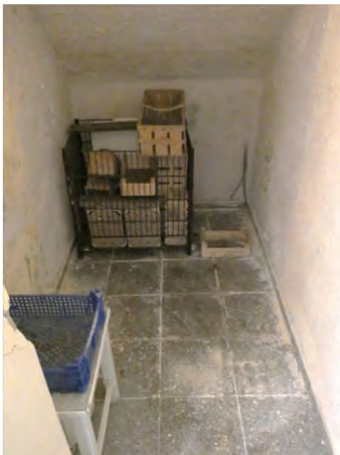
Bild 43: KG Situation Ausblühungen
