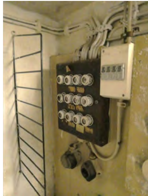
Bild 50: KG Situation Elektrik
