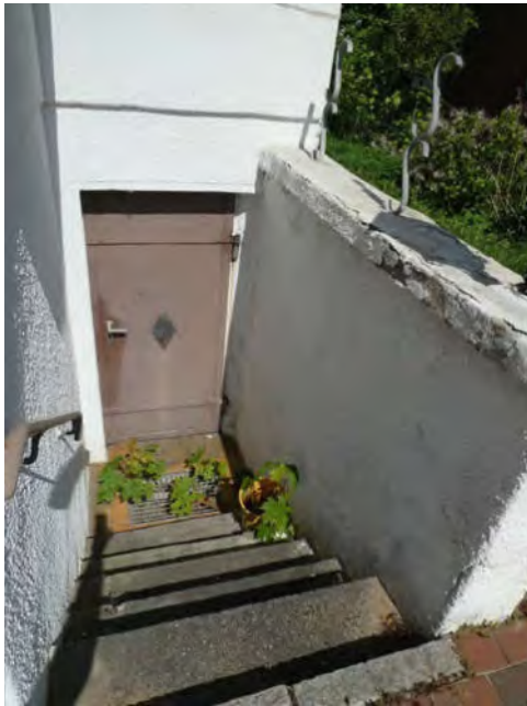
Bild 69: Kelleraußentreppe rückwärtig Rissbildung
