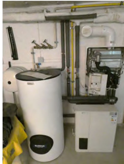
Bild 54: KG Heizungsanlage / Warmwasserspeicher
