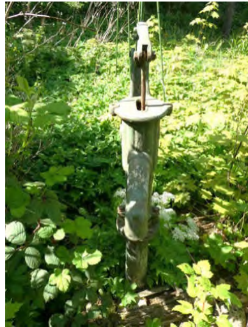
Bild 74: Gartenbereich rückwärtig, Pumpe
