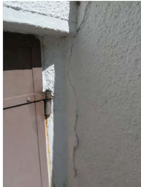
Bild 70: Kelleraußentreppe rückwärtig Rissbildung
