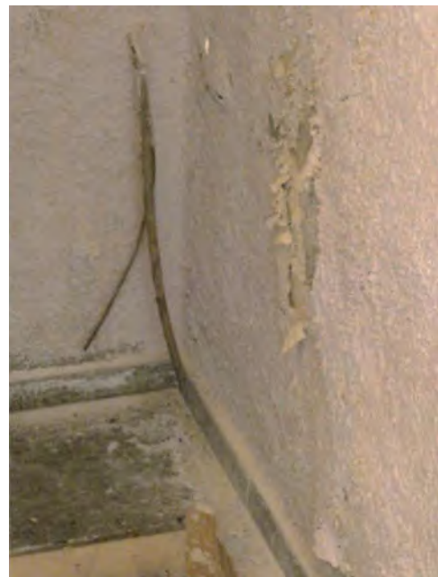
Bild 44: KG Situation Ausblühungen / Feuchtigkeitsschaden
