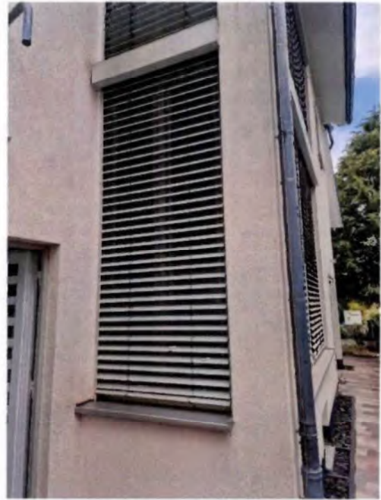
... mit z.T. Außen-Rollos als Sonnenschutz (Erweiterungsbaus)
