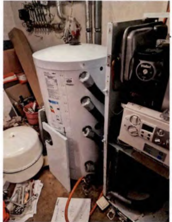
... Gaszentralheizungsanlage (Bauj. 2006, Hersteller: Vaillant, ECO-Compact, VSC 196, Brennwerttechnik) mit zentraler Warmwasserbereitung und z.T. Flachheizkörper (Altbau), z.T. Fußbodenheizung (Erweiterungsbau)
