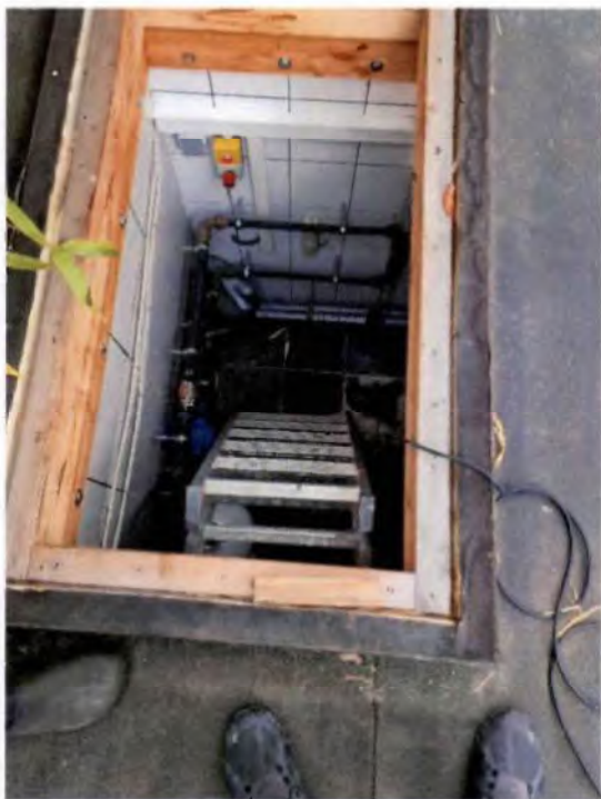
... Technikraum [voll versenkt] mit Filteranlage, Wärmetauscher, Steuerung für Solarmodule, etc.
