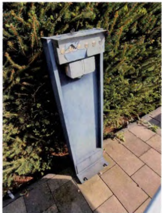
... Steuerungselement (Beleuchtung, Schwalldusche, etc.)
