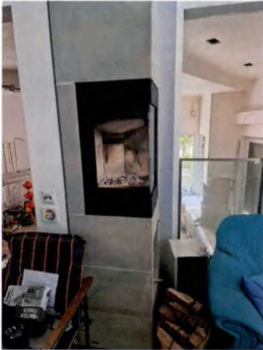
... Kaminofen mit Zulassung ab 2025 (als Einzelofen), Bauj. 2013, Hersteller: Nordpreis, Odense, für feste Brennstoffe [Erweiterungsbau]
