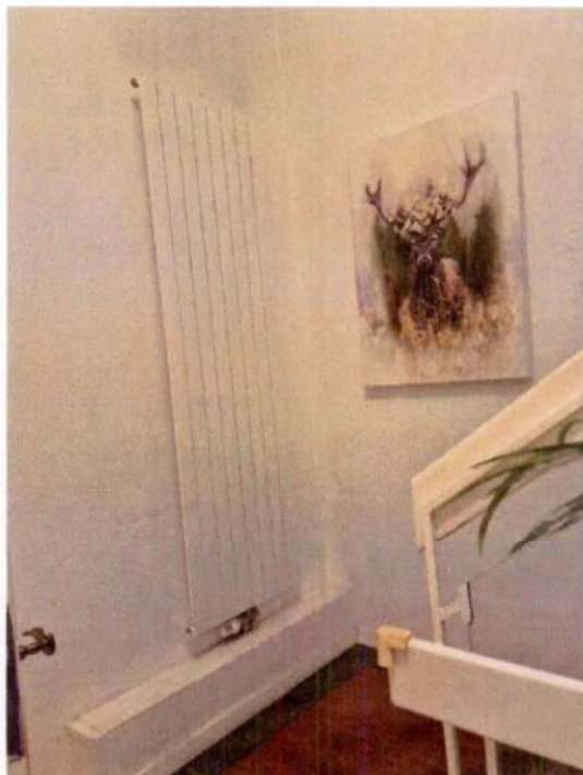
... sowie Design-Heizkörper in der Halle im Erdgeschoss
