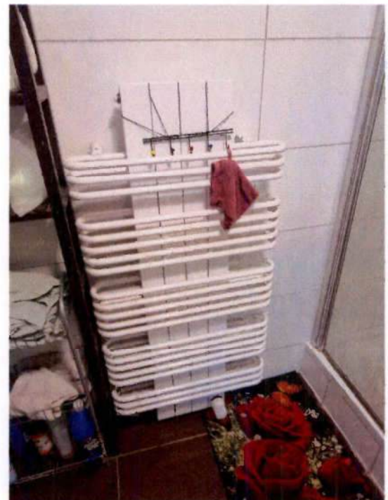
... und Handtuchhalterheizung im Badezimmer im Dachgeschoss
