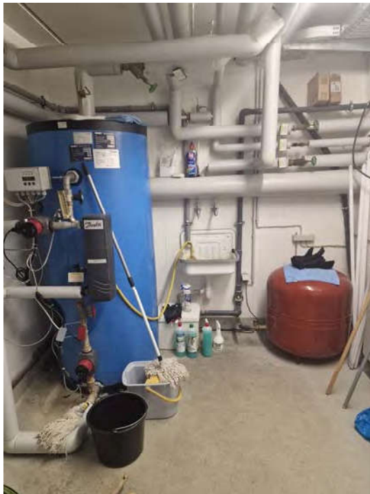
... Fernwärme-Zentralheizungsanlage mit zentraler Warmwasserbereitung
