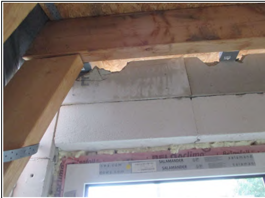
Bild 21 (Dachanschluss / Fassade offen)
