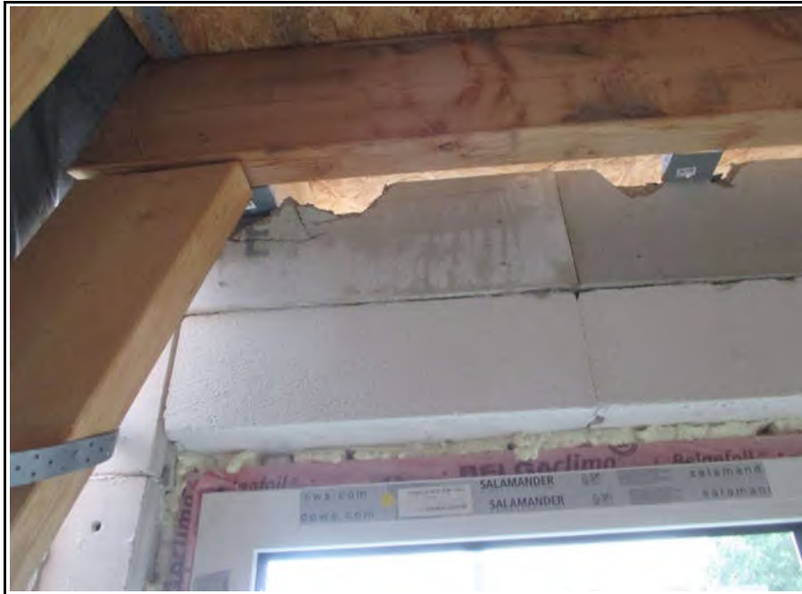
Bild 21 (Dachanschluss / Fassade offen)
