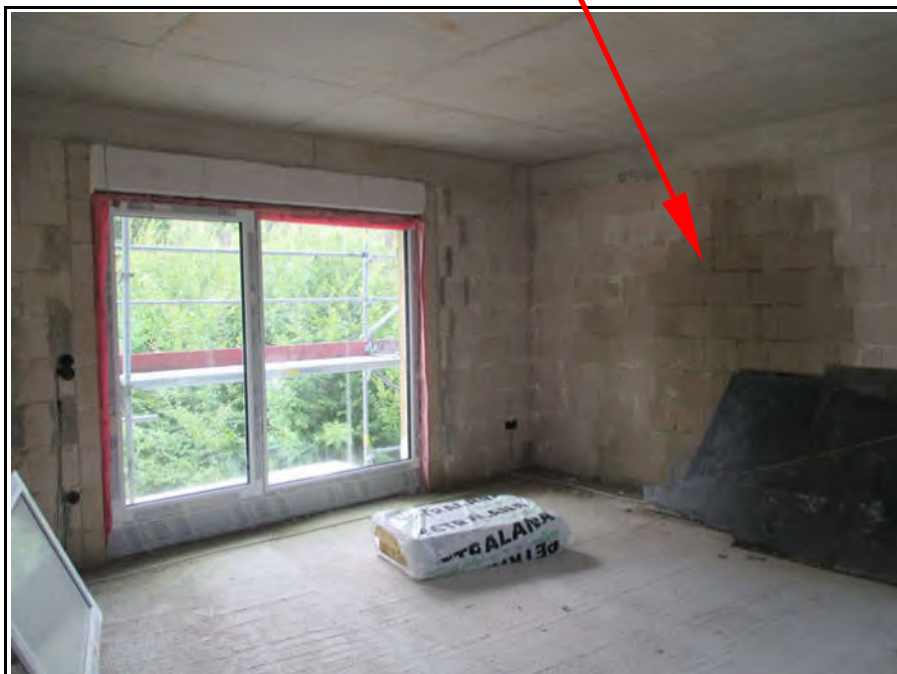
Bild 18 (Wohnraum Wohnung IV im OG, feuchte Innenwand)
