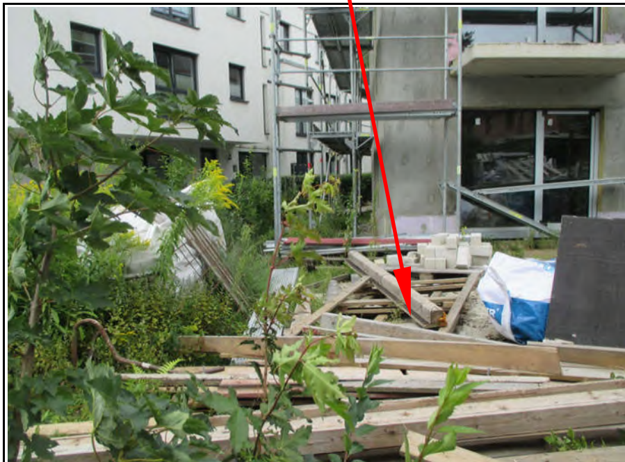
Bild 6 (Bewertungsobjekt, Bauschutt und Konstruktionsholz im Vorgarten)
