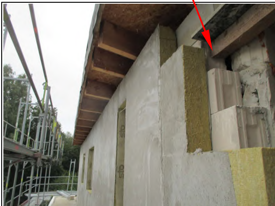
Bild 24 (Staffelgeschoss, Dämmung und Mauerwerk ungeschützt gegen Regen)
