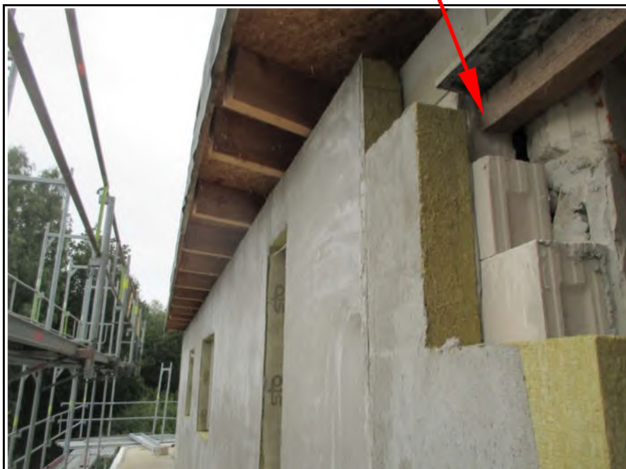
Bild 24 (Staffelgeschoss, Dämmung und Mauerwerk ungeschützt gegen Regen)
