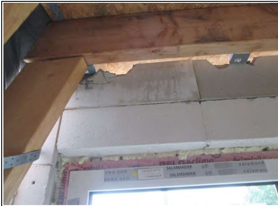
Bild 21 (Dachanschluss / Fassade offen)
