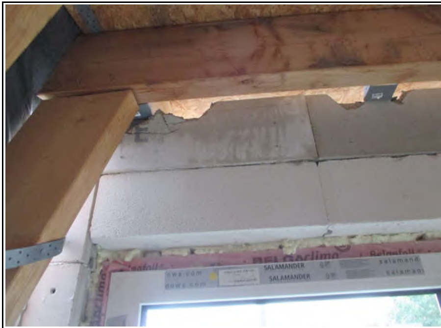
Bild 21 (Dachanschluss / Fassade offen)
