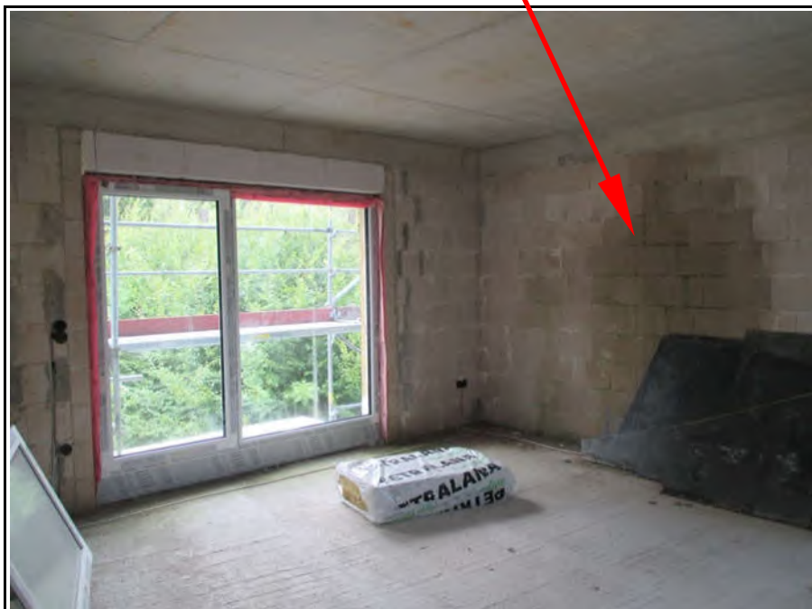
Bild 18 (Wohnraum Wohnung IV im OG, feuchte Innenwand)
