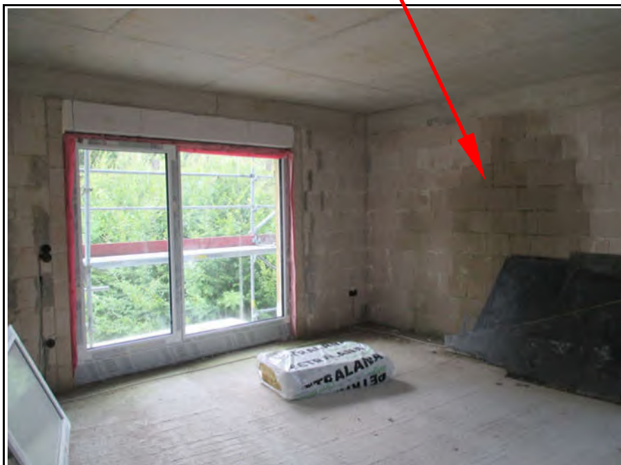
Bild 18 (Wohnraum Wohnung IV im OG, feuchte Innenwand)
