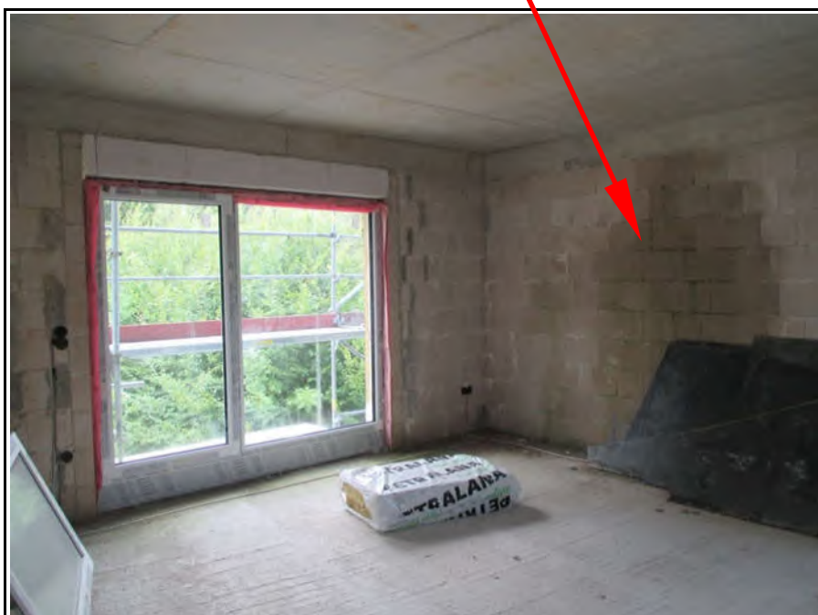
Bild 18 (Wohnraum Wohnung IV im OG, feuchte Innenwand)
