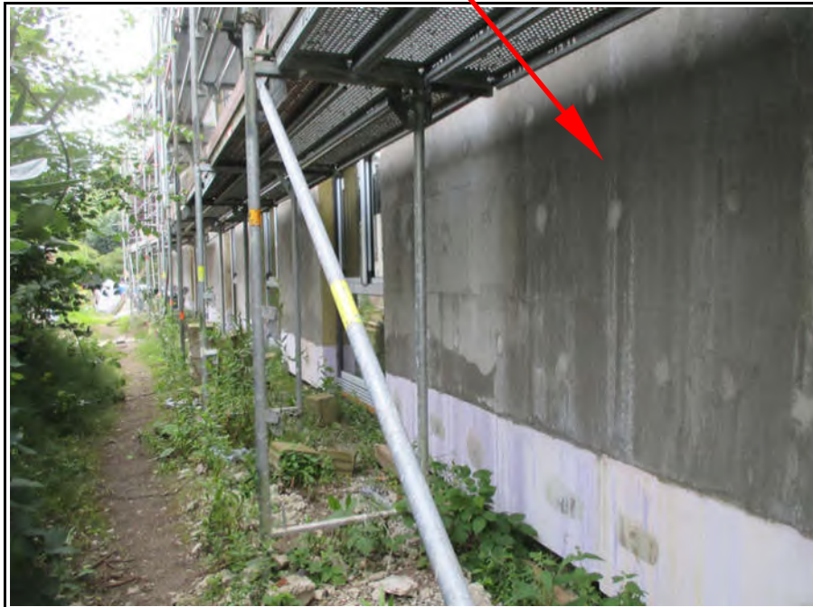
Bild 5 (Seitenansicht, Feuchtigkeit in der Dämmfassade)
