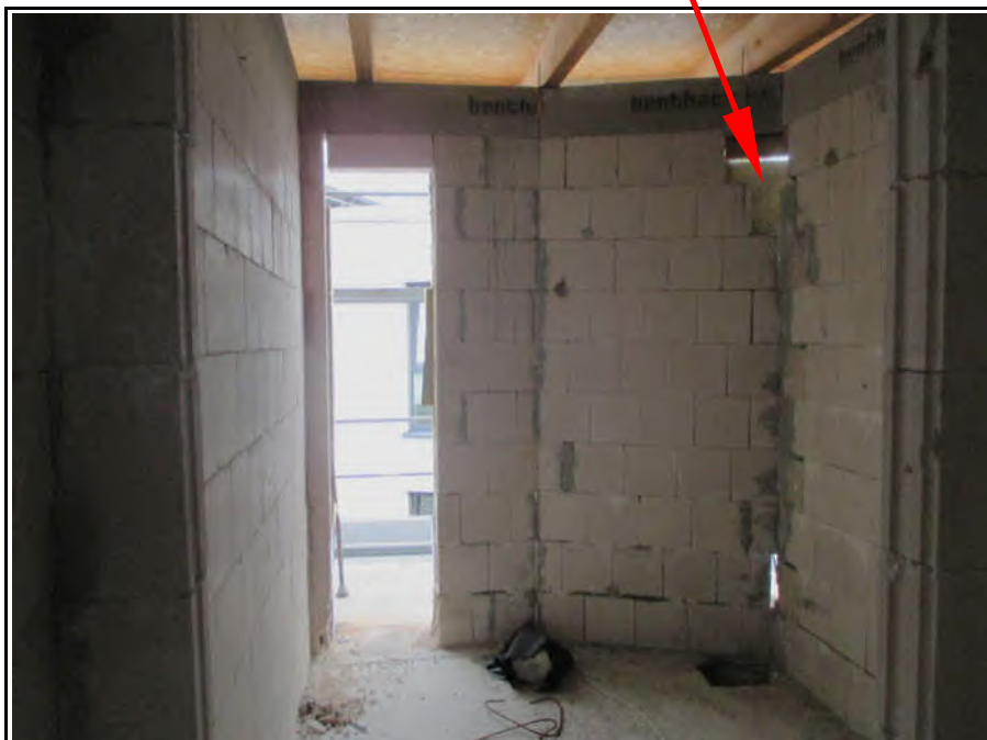
Bild 22 (Raum im Staffelgeschoss, Mauerwerksanschluss offen)
