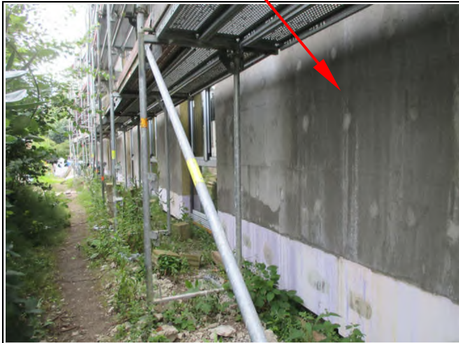
Bild 5 (Seitenansicht, Feuchtigkeit in der Dämmfassade)
