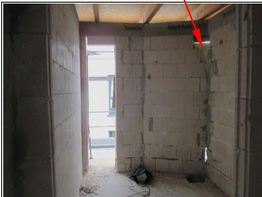
Bild 22 (Raum im Staffelgeschoss, Mauerwerksanschluss offen)
