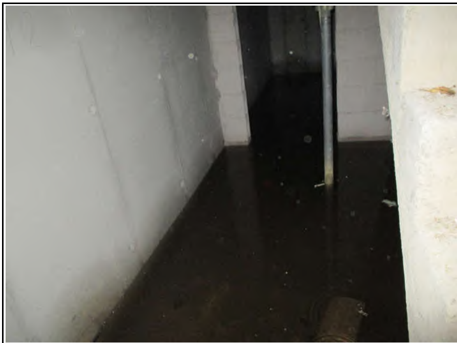
Bild 10 (Blick in den Keller, hier steht Wasser)
