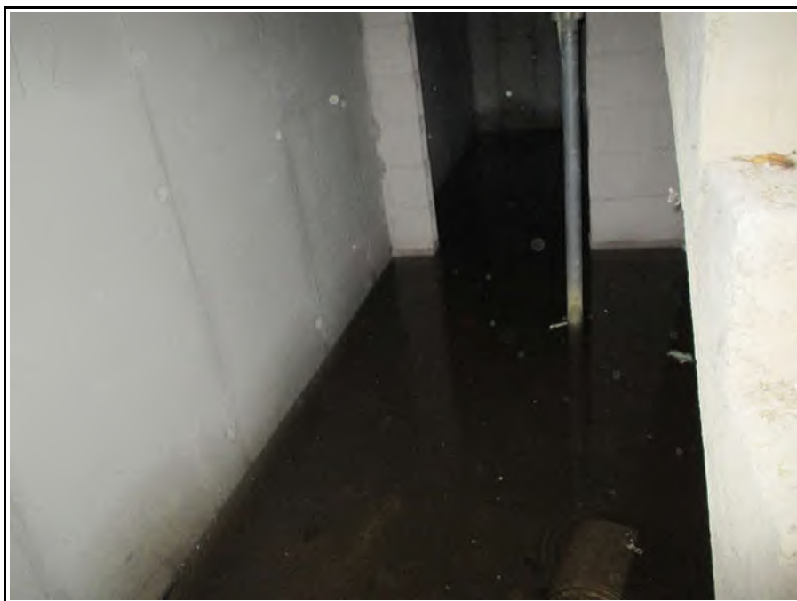
Bild 10 (Blick in den Keller, hier steht Wasser)
