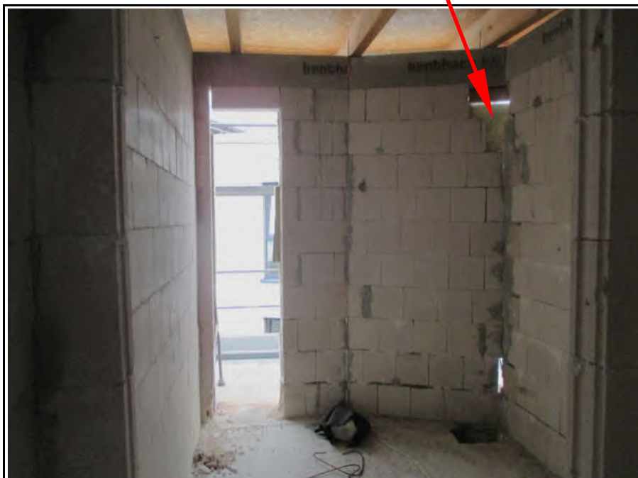
Bild 22 (Raum im Staffelgeschoss, Mauerwerksanschluss offen)
