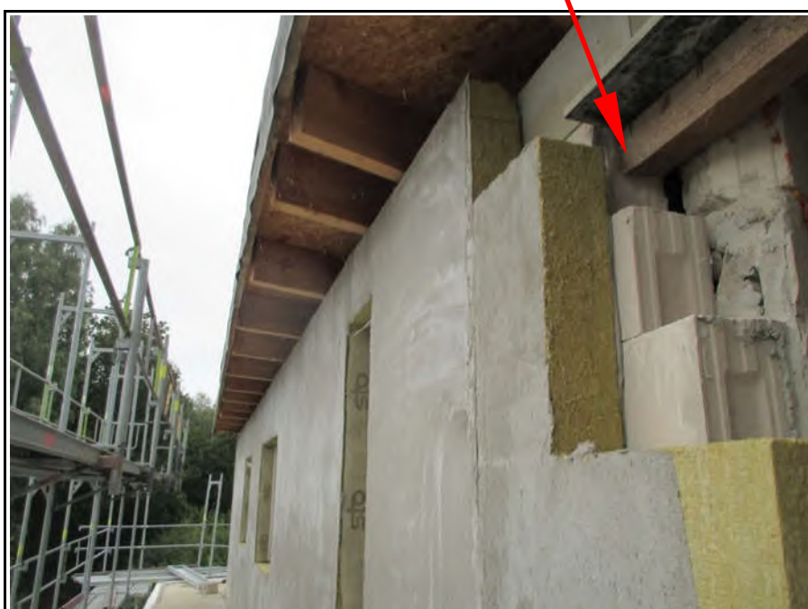
Bild 24 (Staffelgeschoss, Dämmung und Mauerwerk ungeschützt gegen Regen)
