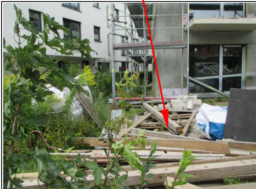
Bild 6 (Bewertungsobjekt, Bauschutt und Konstruktionsholz im Vorgarten)
