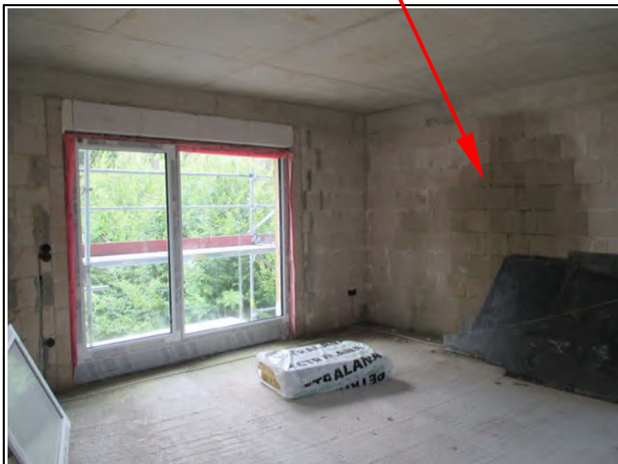
Bild 18 (Wohnraum Wohnung IV im OG, feuchte Innenwand)
