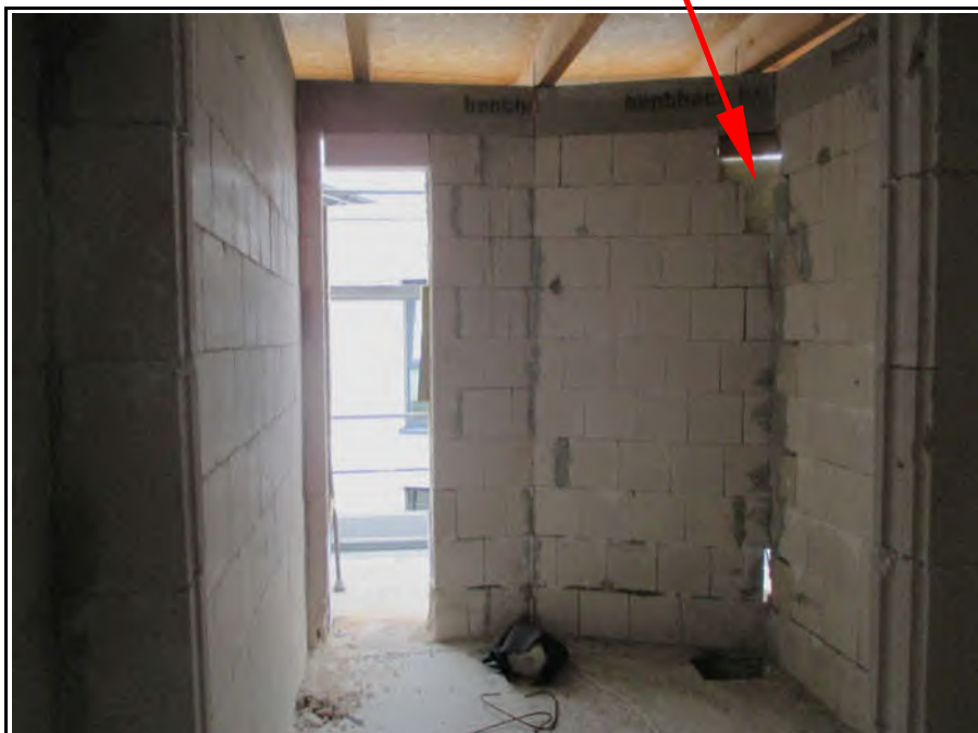
Bild 22 (Raum im Staffelgeschoss, Mauerwerksanschluss offen)
