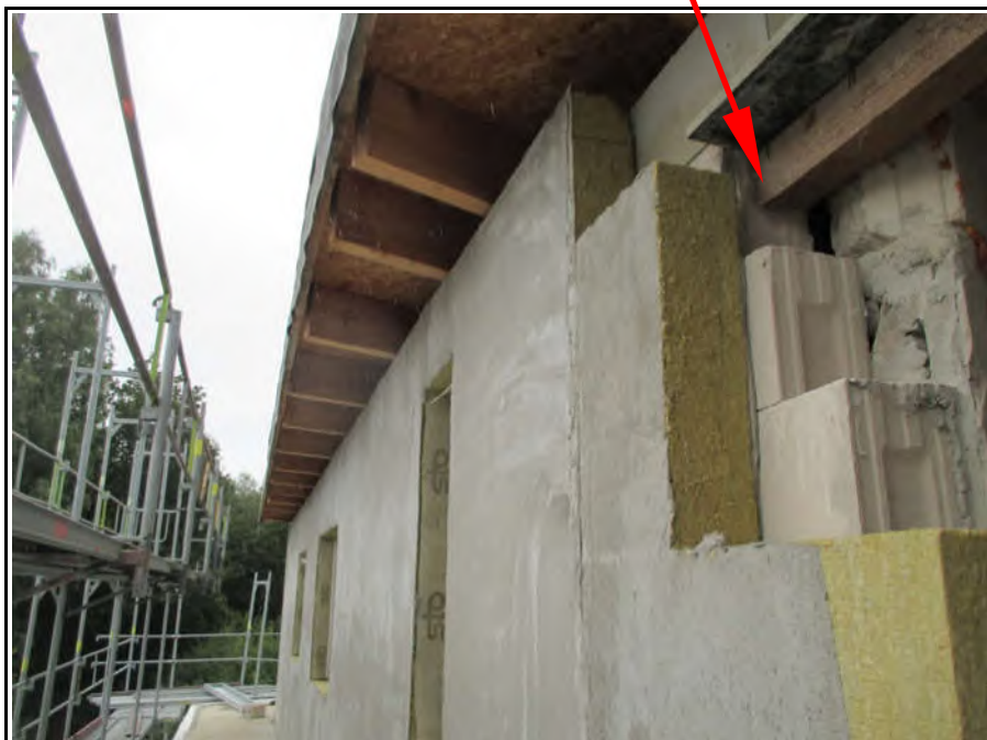
Bild 24 (Staffelgeschoss, Dämmung und Mauerwerk ungeschützt gegen Regen)
