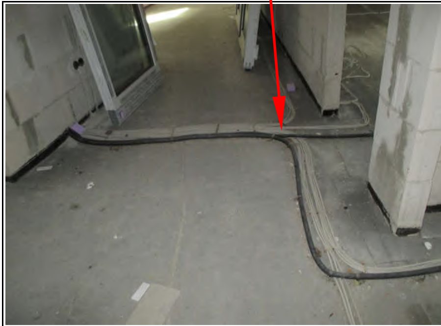
Bild13 (Elektroleitungen sind überwiegend vorhanden)
