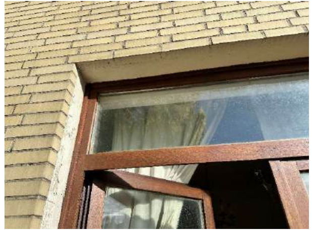
Obergeschoss – Fassade im Bereich der Balkontür
