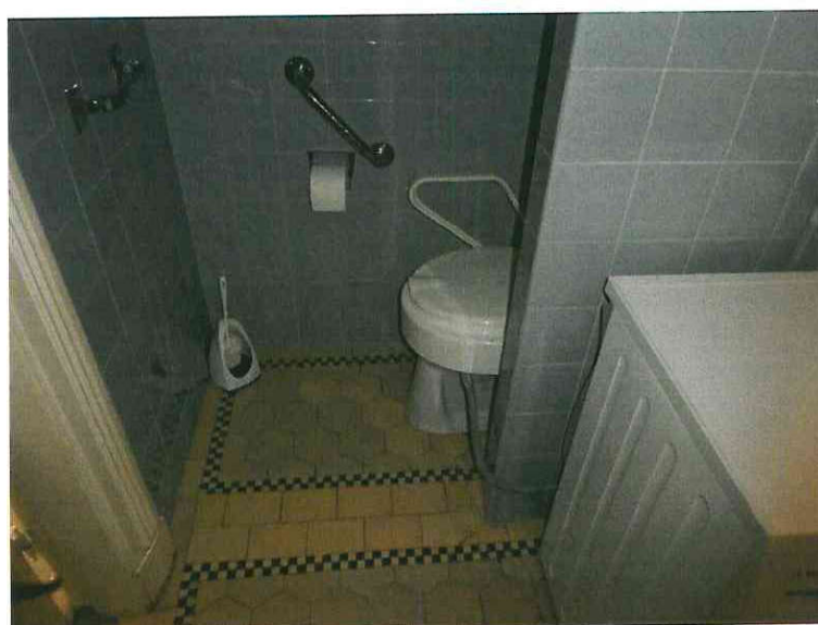
Bild 21: Sanitärausstattung Wohnung Obergeschoss
