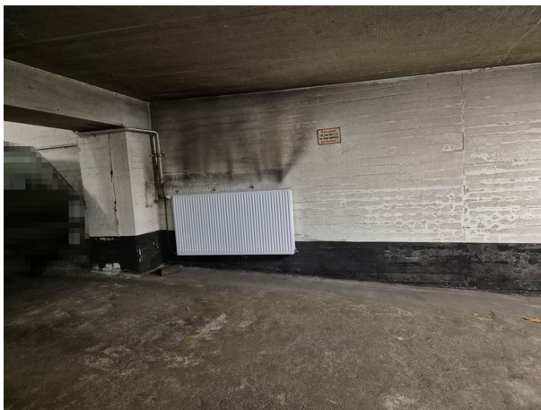
Heizung in der Tiefgarage an der nordwestlichen Giebelseite
