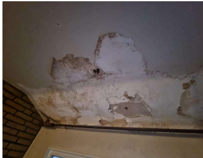
Durchfeuchtung im Windfang im Bereich des Daches
