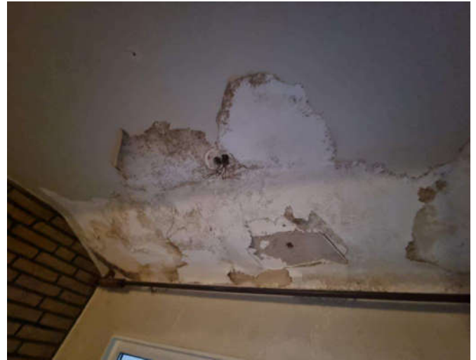
Durchfeuchtung im Windfang im Bereich des Daches
