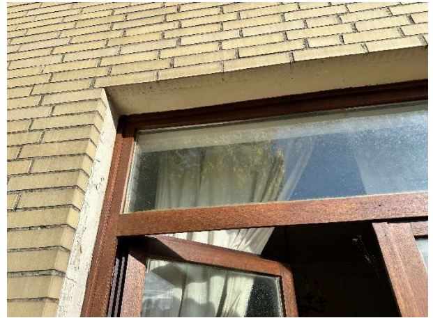
Obergeschoss – Fassade im Bereich der Balkontür
