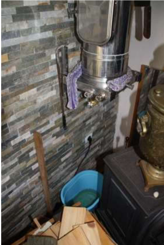
Kondenswasserbildung am Kaminofenrohr
