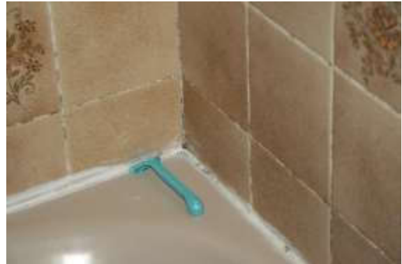
Zustand der Fugen an der Badewanne
