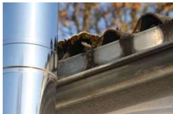
Moosbewuchs auf dem Dach
