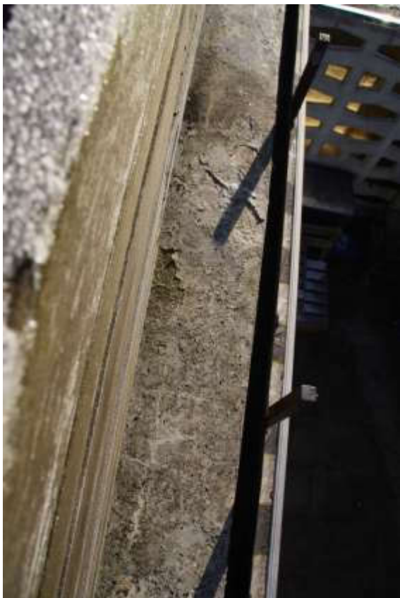
Erhaltungszustand des auskragenden Betonbalkonbodenplatte
