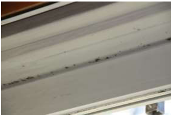
Schimmelbildung im oberen Bereich der Fenster
