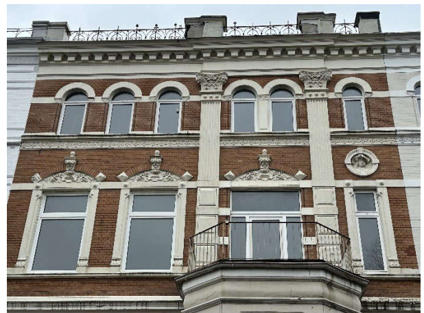
fehlender Putz an Pfostenköpfen
