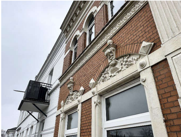
Fassadenstück mit Durchfeuchtungen
