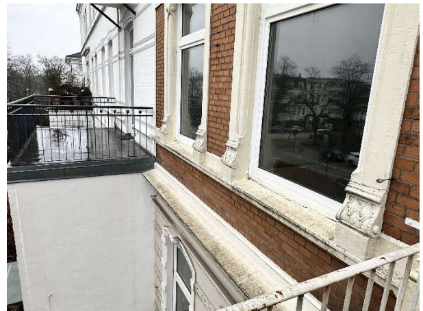
Fensterbänke, Simse mit Feuchteschäden
