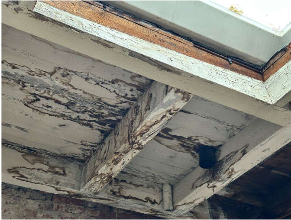
Dachgeschossdecke - Gartenseite teilweise stark durchfeuchtet mit Schwammbefall
