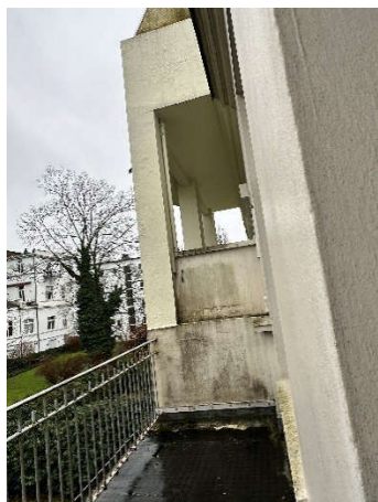
1. Obergeschoss – Gartenseite Balkon mit Feuchteschäden
