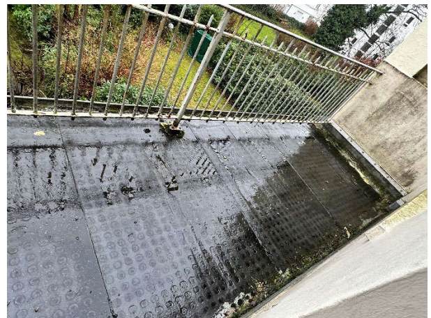
Balkon – 1. Obergeschoss Gartenseite Belag und Geländer modernisierungsbedürftig
