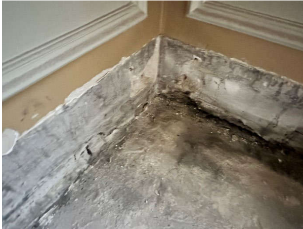
Erdgeschoss – Straßenseite Außenwände mit Feuchteschäden
