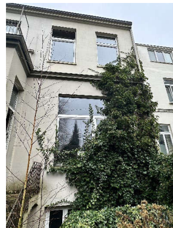
Gartenfassade – Obergeschosse mit Feuchteschadenbildern
