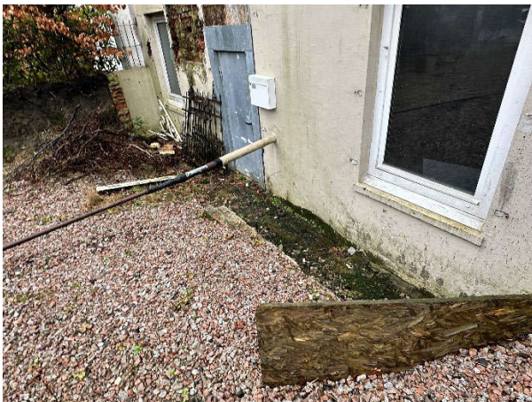
Kellerfassade mit Feuchteschäden
