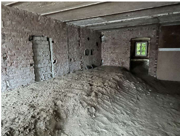
Keller – Nordseite (komplett) fehlendes bzw. unzureichendes Fundament bzw. Bodenbelag
