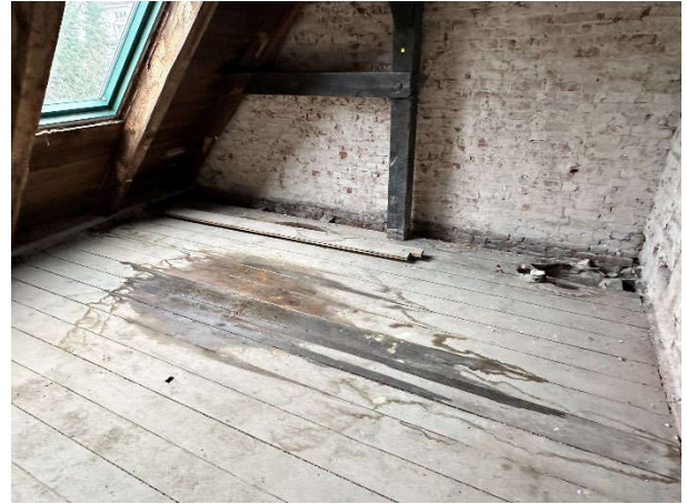
Dachgeschoss- Gartenseite Feuchteschäden an Dach, Schrägen und Fußboden
