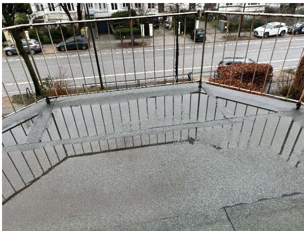
Balkon – 1. Obergeschoss Straßenseite Belag und Geländer modernisierungsbedürftig
