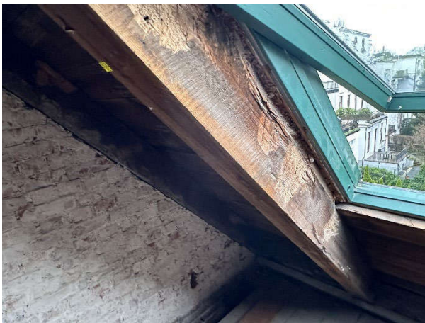
vormalige Schäden an Dachbalken
