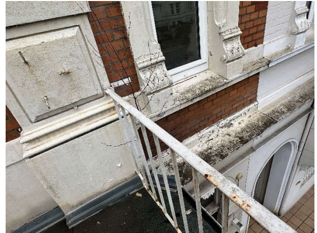
Fensterbänke, Simse mit Feuchteschäden
