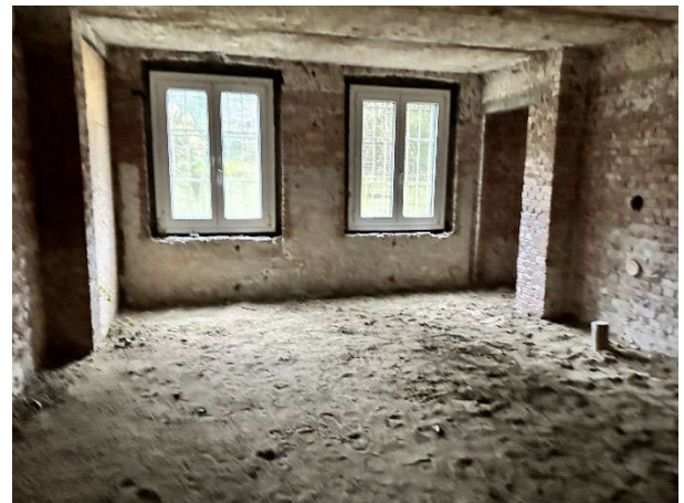
Keller – Zimmer 2 Fehlender Bodenbelag
