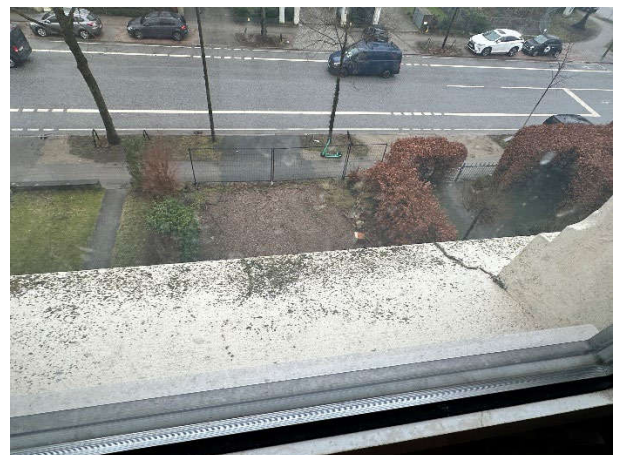
typische Fensterbank mit Feuchteschäden, hier auch mit Bruchstelle
