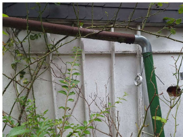
verwinkelte und zusammengestückelte Fallrohre
