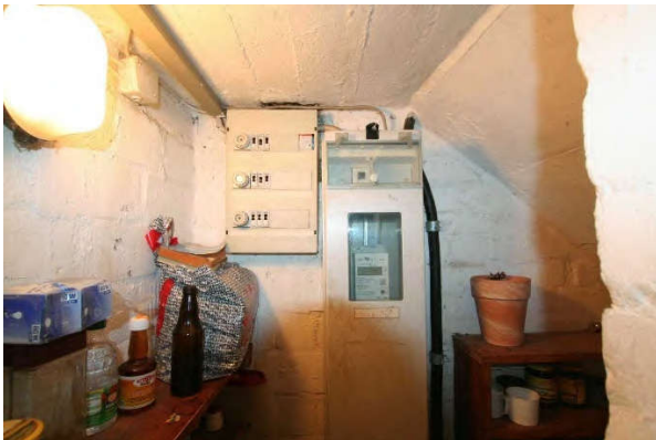
Sicherungen und Stromzähler
