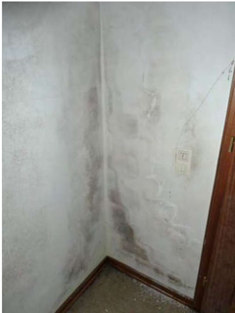
Bild 65: Situation Schimmelpilzbefall / Stockflecken
