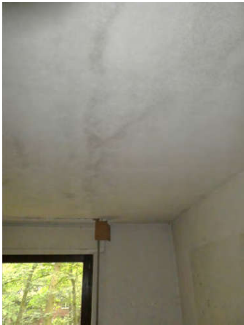
Bild 77: Situation Feuchtigkeitsschaden o.ä.
