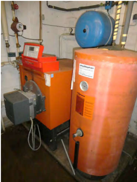
Bild 41: Souterrain Keller Heizungsanlage
