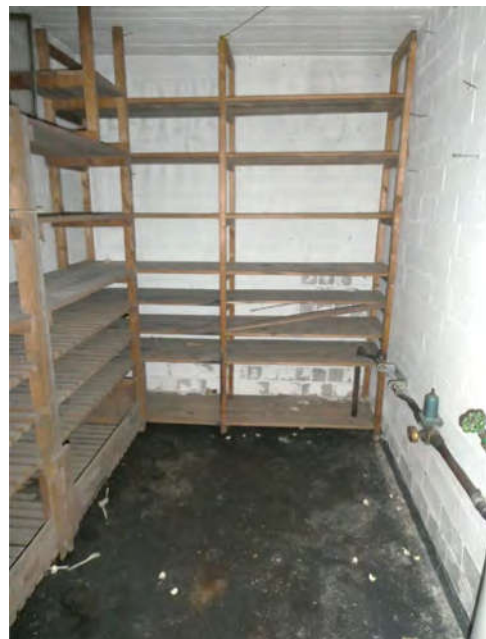
Bild 44: Souterrain Keller neben Heizungsanlage
