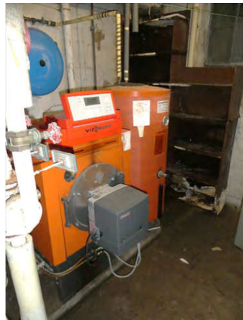
Bild 40: Souterrain Keller Heizungsanlage
