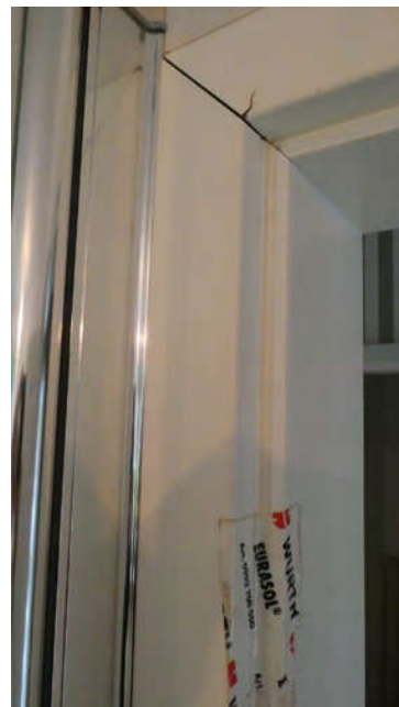
Bild 24: Bad, Situation Türrahmen
