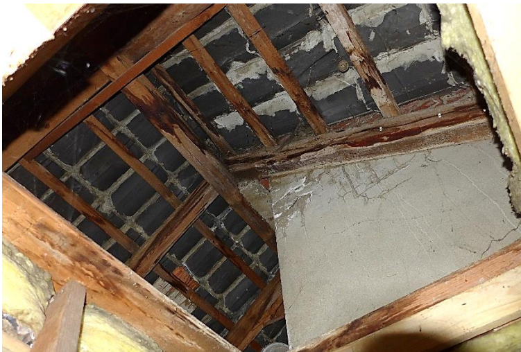
17. Dachunterseite nicht gedämmt
