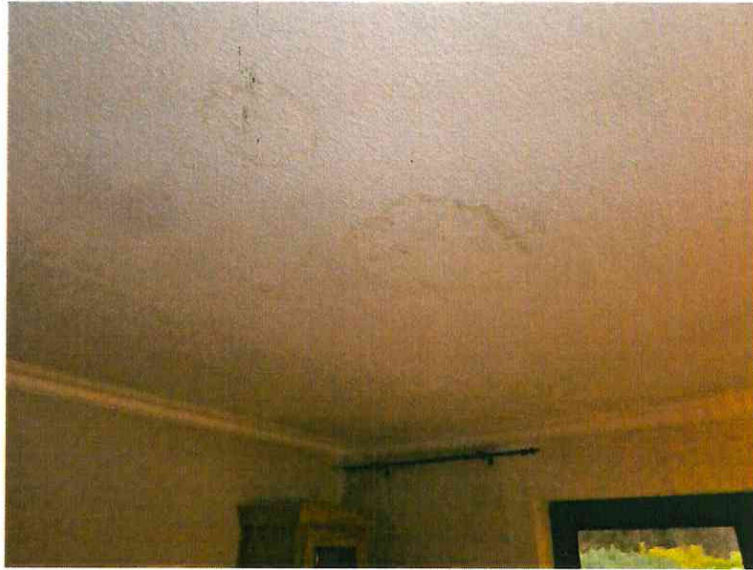
Bild 19: Durchfeuchtung / defekte Dachabdichtung
