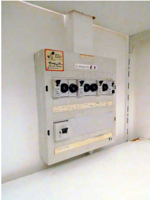
Bild 16: Abstellen / Situation Elektrik
