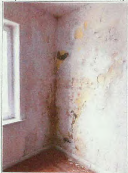
DG, Bereich der entfernten Leckage
