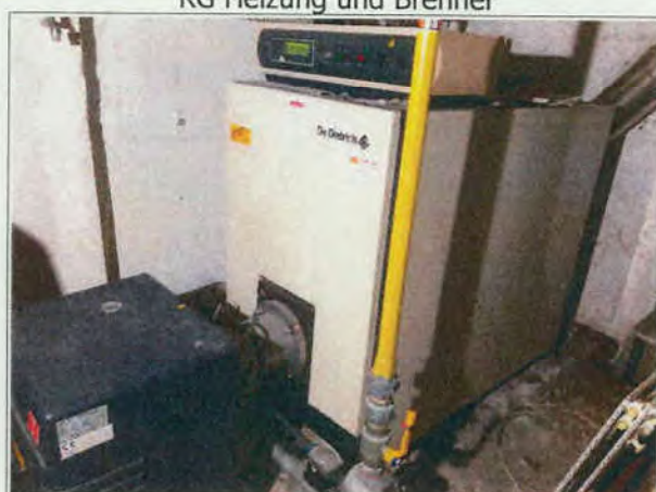
KG Heizung und Brenner
