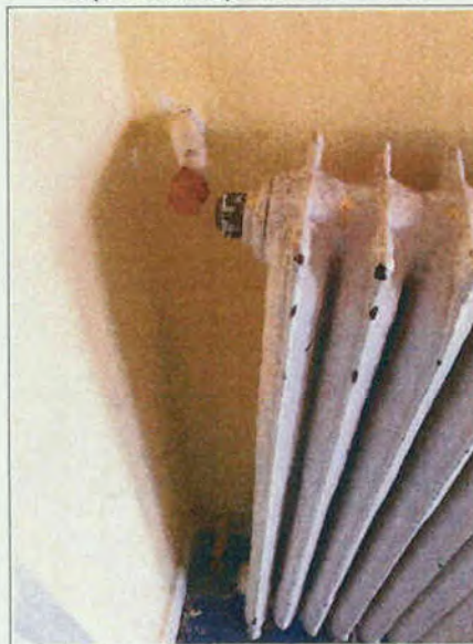
Bsp. Heizkörper 3. OG WE 9
