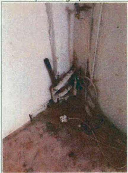
Bsp. Leitungen, 3. OG
