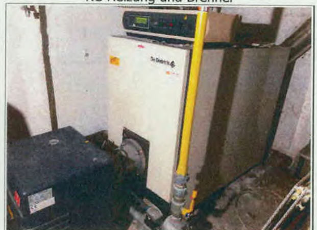
KG Heizung und Brenner
