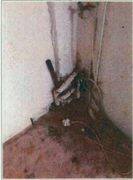
Bsp. Leitungen, 3. OG
