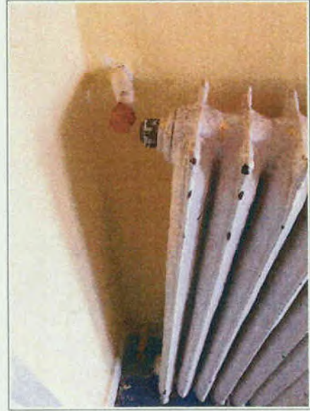
Bsp. Heizkörper 3. OG WE 9
