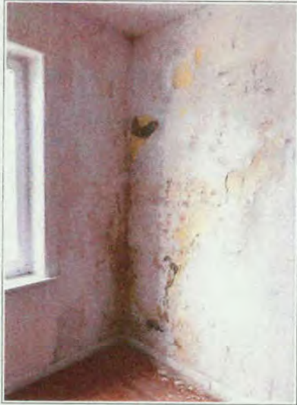
DG, Bereich der entfernten Leckage
