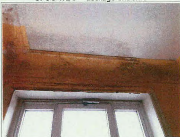
3. OG WE 9 – Leckage entfernt
