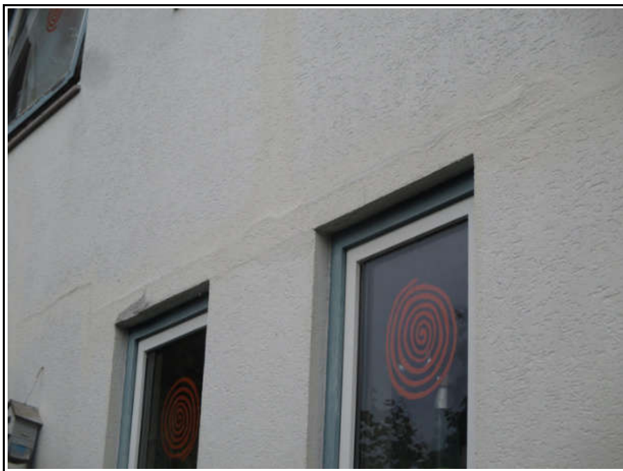
Bild 47 (Fassade Giebel an der Straße, Absetze ggf. Risse)
