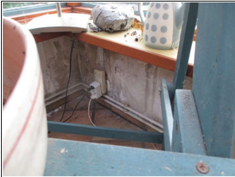
Bild 19 ( Wintergarten: Feuchtigkeit im Sockelbereich)
