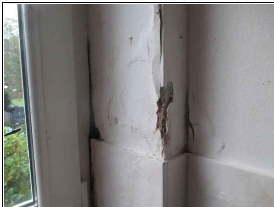
Bild 10 (WC im EG, Feuchtigkeiterscheinungen)
