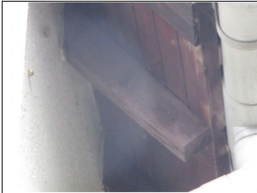
Bild 49 (Dachunterseite, Anstrich erforderlich)
