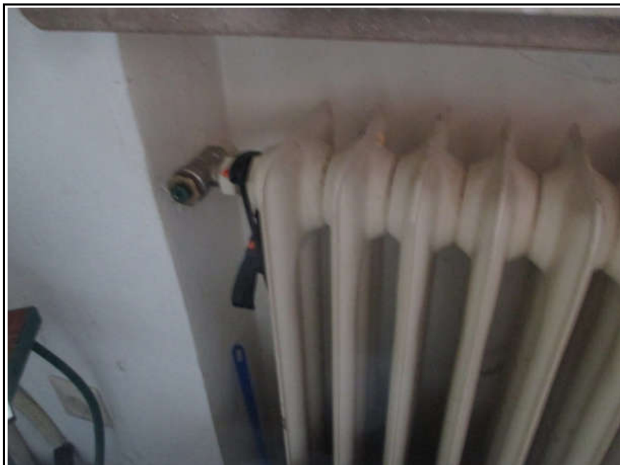
Bild 24 (EG Rippenheizkörper, Thermostatventil fehlt)
