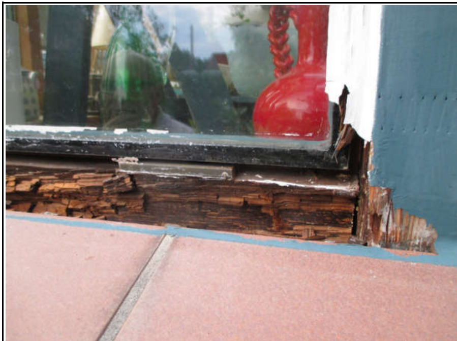
Bild 20 ( Wintergarten: Fenster stark verwittert, Wüfelbruch)
