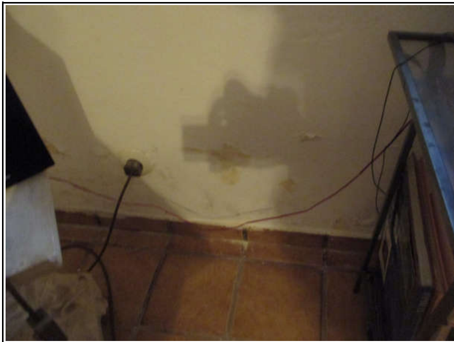
Bild 37 (Zimmer im Keller, Feuchtigkeit im Sockelbereich)
