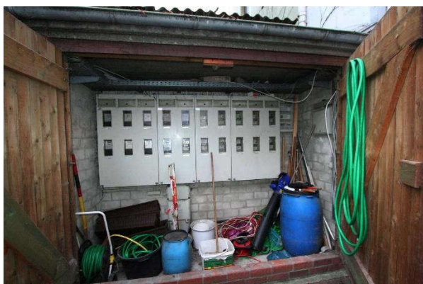
Stromzähler außen zwischen Vorderhaus und Hinterhofgebäude
