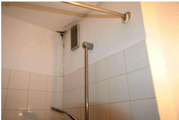
Feuchtigkeitsproblem im Badezimmer von Wohnung 6 im 1. OG des Vorderhauses
