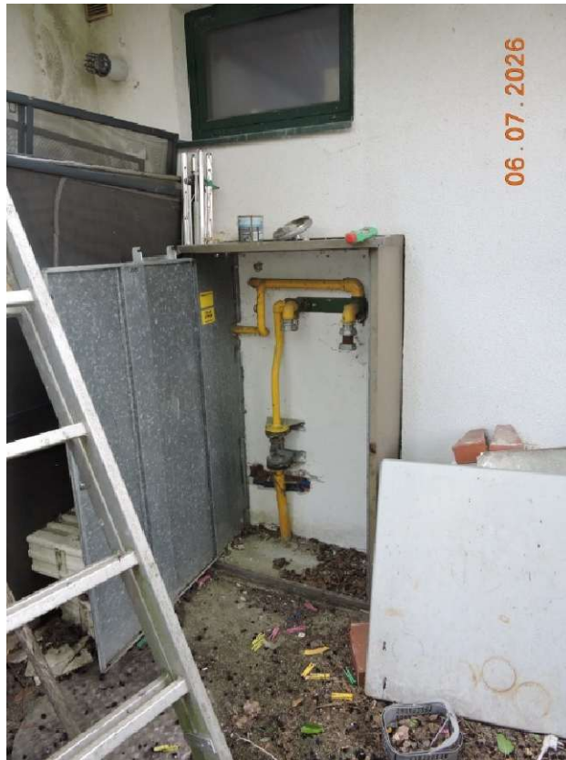
Gashauptzuleitung mit demontiertem Gaszähler
