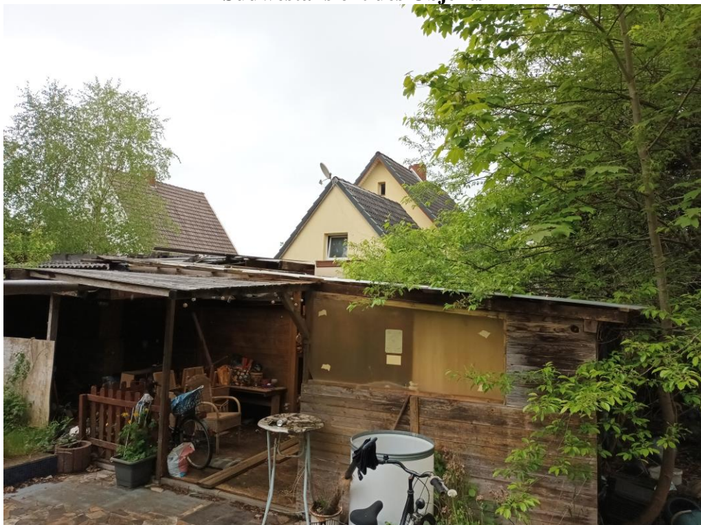
Detailaufnahme Südostansicht mit baufälligen, nicht genehmigten Bauten im Vordergrund
