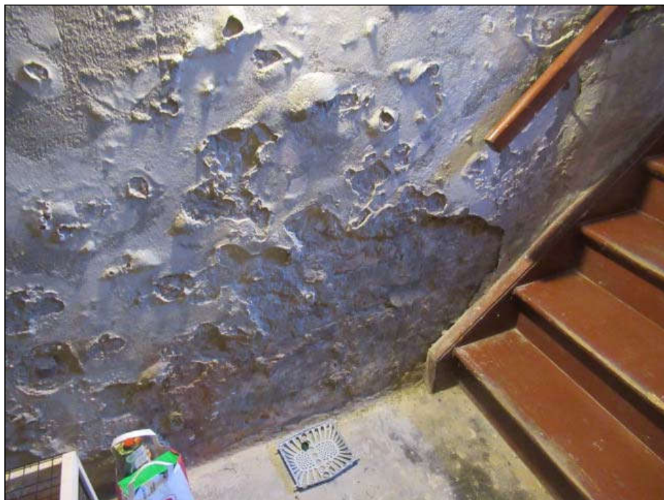
Ausblühungen im Keller
