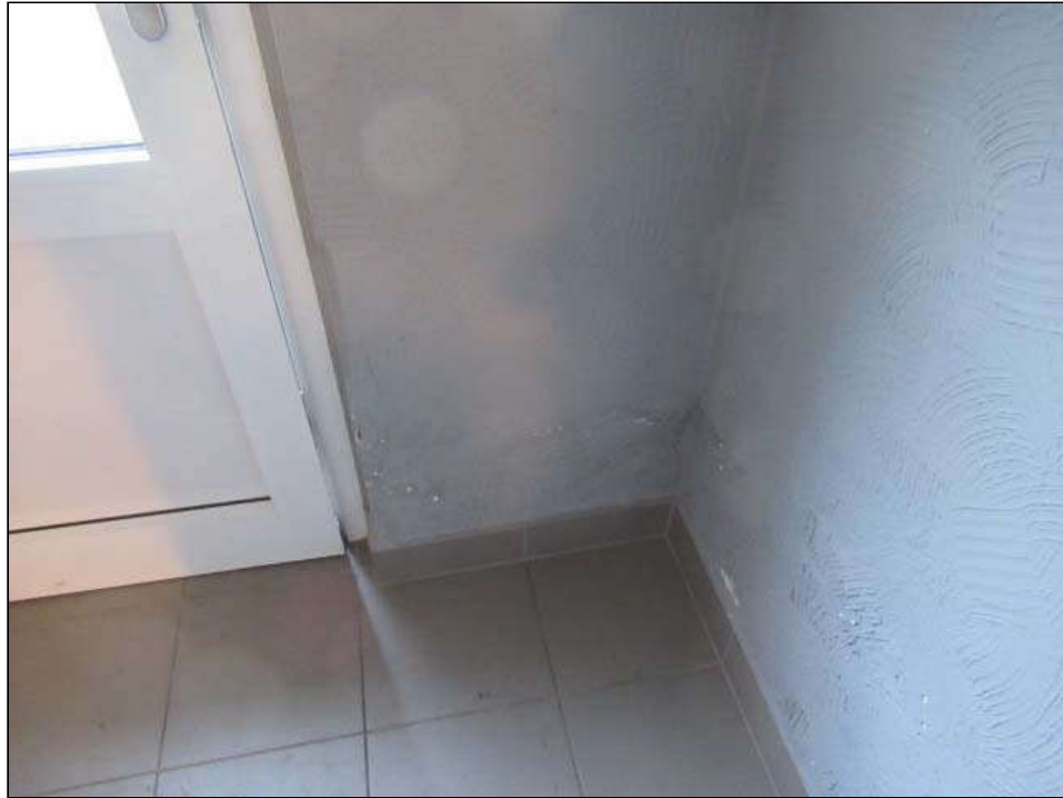
Ausblühungen am Zugang
