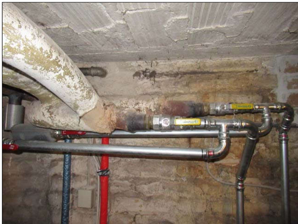
Leitungssysteme im Keller
