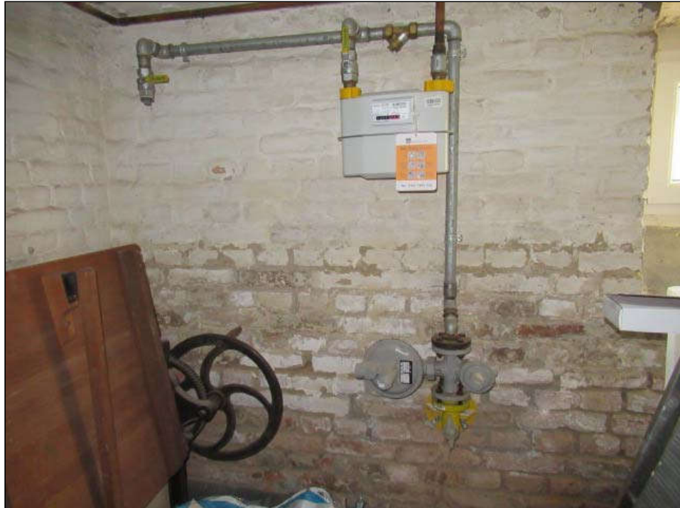
Ausblühungen im Keller
