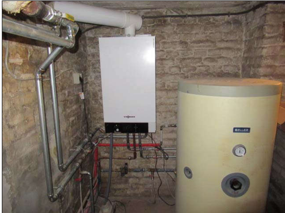
Gaszentralheizung im Keller
