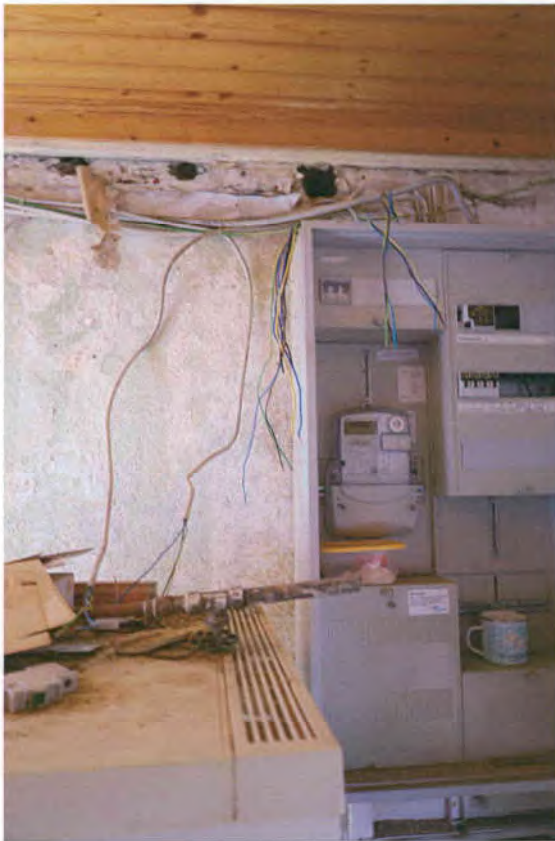
Neuer Elektrosicherungskasten (Elektrozähler)
