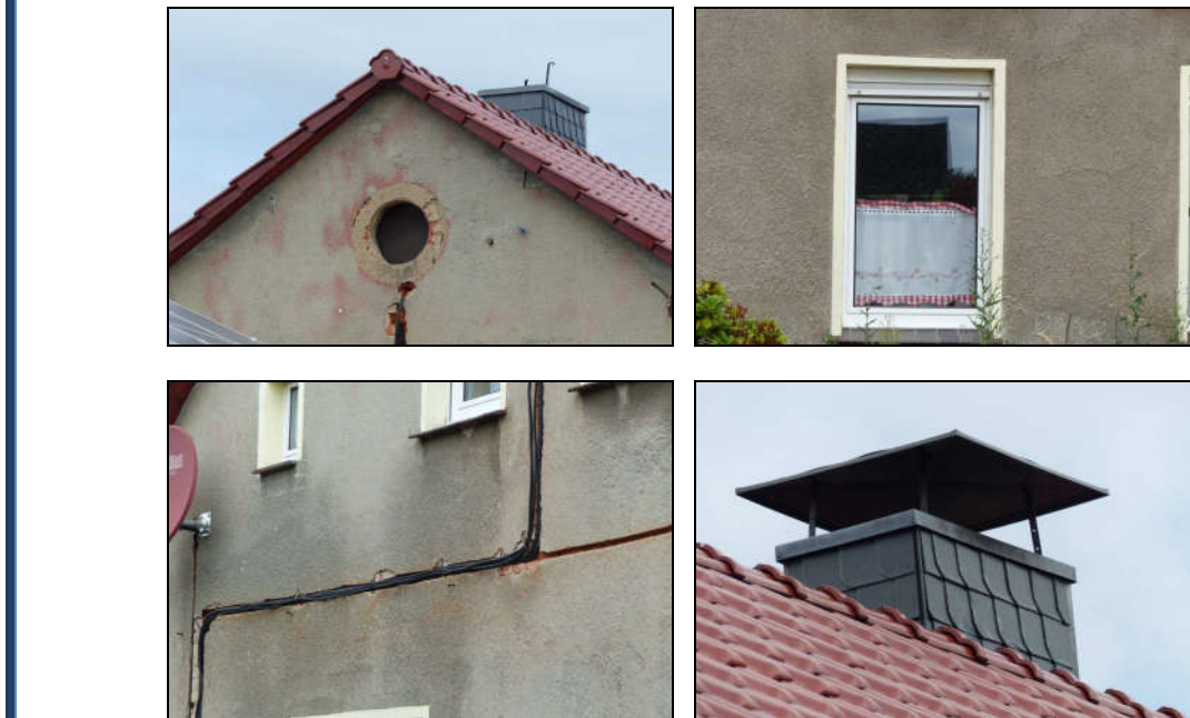
Abbildung 5: Detailansichten der Dacheindeckung und der Fassade (tlw. Fertigstellungsbedarf nach Elektroinstallationsarbeiten)
