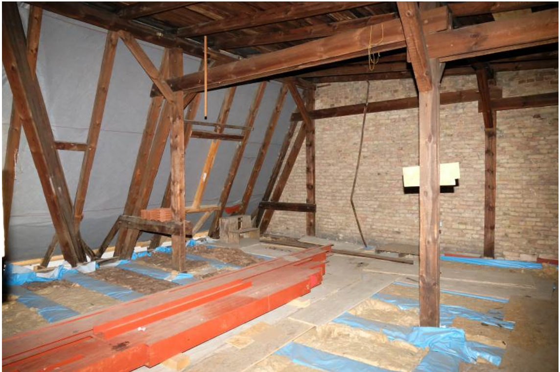
Dachgeschoss, Träger nicht eingebaut Teileigentum #17
