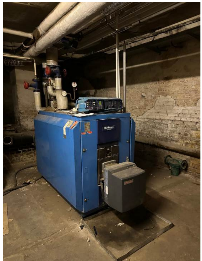
Ölzentralheizung im Keller
