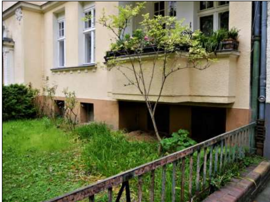
straßenseitige Front des auf dem Grundstück Liliencronstraße 13 aufstehenden Mietwohnhauses im Bereich des Hochparterres mit über Terrain aufgehenden Fenstern im Kellergeschoss
