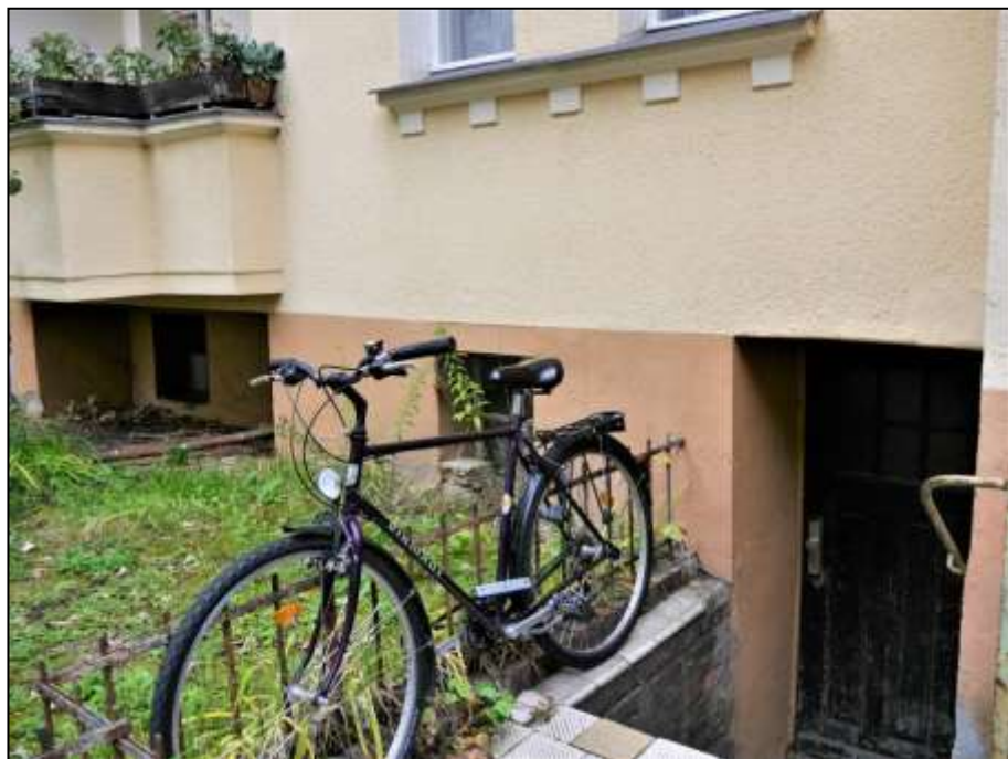
straßenseitige Front des auf dem Grundstück Liliencronstraße 13 aufstehenden Mietwohnhauses im Bereich des Hochparterres mit über Terrain aufgehenden Fenstern im Kellergeschoss und Kellerzugang aus dem Vorgartenbereich
