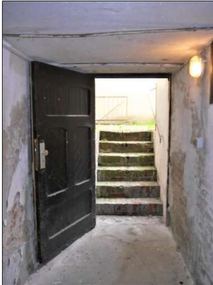
Außentür zur Kelleraußen- treppe aus dem Hofbereich in den Gebäude- durchgang im Kellergeschoss des Vorderhau- ses
