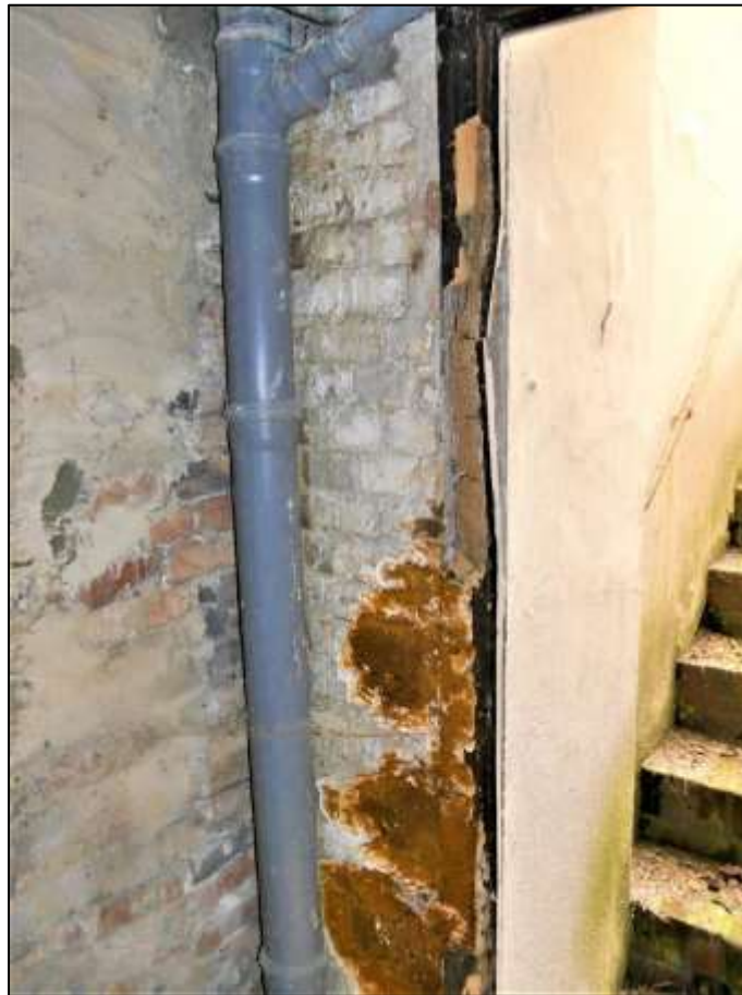
Kellerzugang über die davor belegene Keller- raußentreppe in den Seitenflü- gel mit erheblichem Pilzbefall vermtl. als brauner Poren- schwamm oder ggf. Echter Hausschwamm
