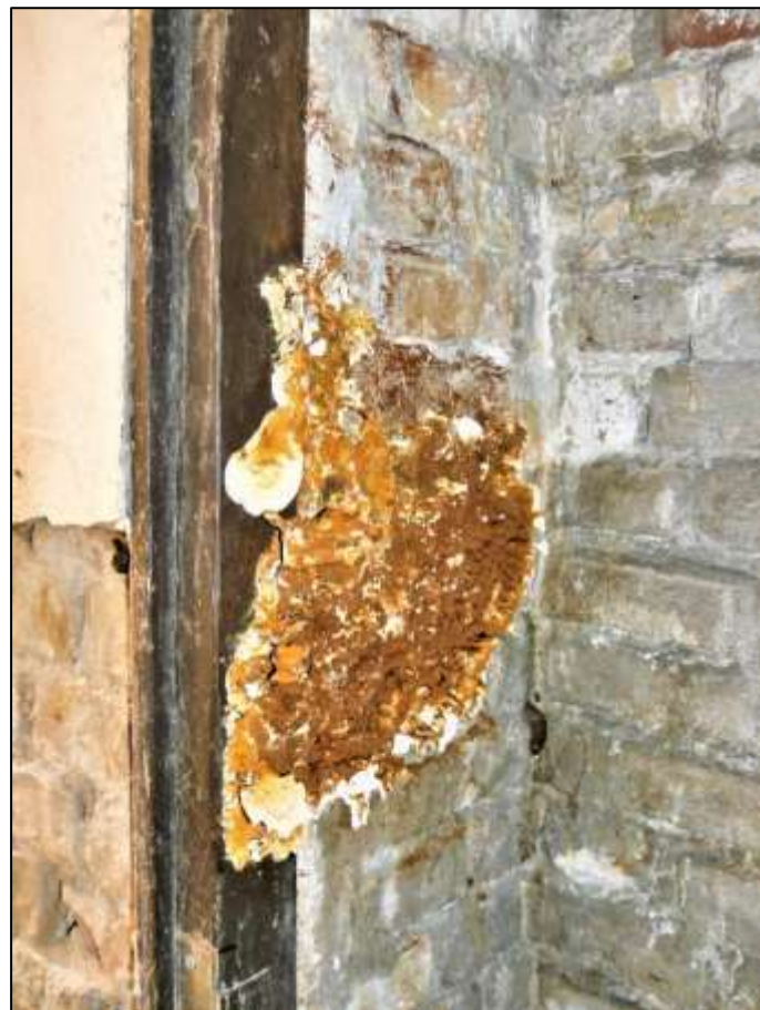
Kellerzugang über die davor belegene Kelle- raußentreppe in den Seitenflügel mit erheblichem Pilzbefall ver- mtl. als brauner Porenschwamm oder ggf. Echter Hausschwamm
