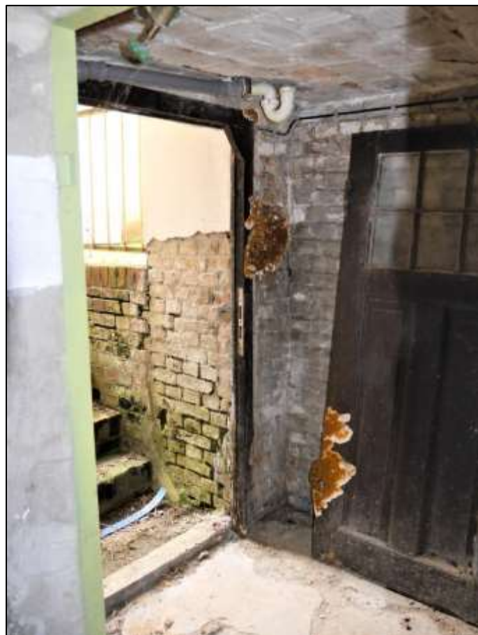
Kellerzugang über die davor belegene Kelle- raußentreppe in den Seitenflügel mit erheblichem Pilzbefall ver- mtl. als brauner Porenschwamm oder ggf. Echter Hausschwamm
