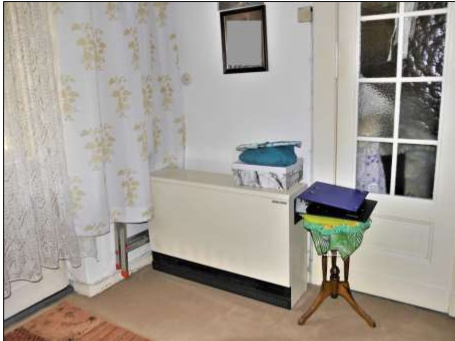
Nachstromspeicherheizgeräte einer im Hochparterre im Vorderhaus belegten Wohnung
