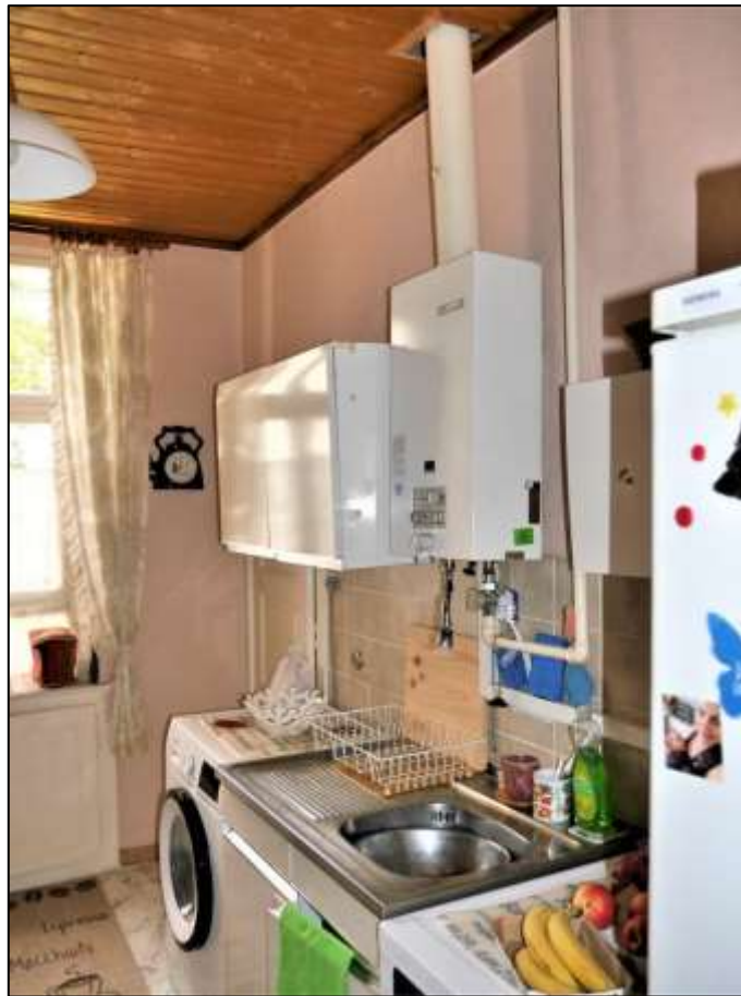
Küche einer im Hochparterre im Vorderhaus belegenen Wohnung mit Warmwasser-Gas-Durchlauferhitzer
