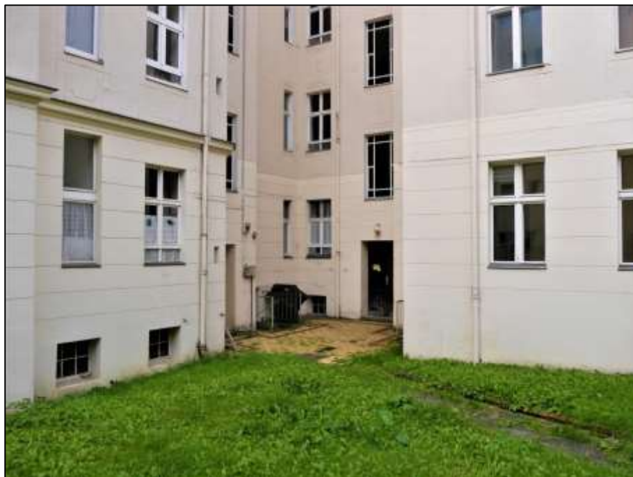
rückwärtige Front des Vorderhauses im Zwickel von Vorderhaus und anbindendem Seitenflügel mit davor belegtem Zuwegungsbereich
