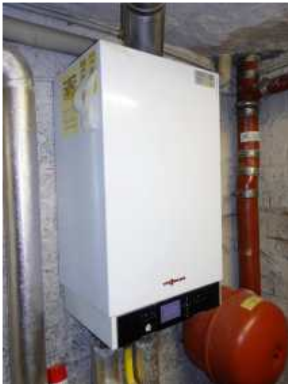
Zentrale Gastherme für alle Wohnungen des Treppenaufgangs.
