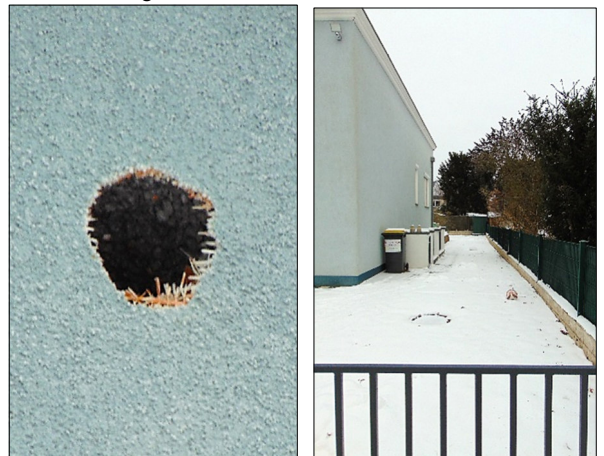
Foto 6/6a Links: Ausschnitt Südfassade/Straßenfassade mit Fehlstelle im augenscheinlichen Wärmedämmverbundsystem. Rechts: Blick Richtung Norden entlang der östlichen Grundstücksgrenze.
