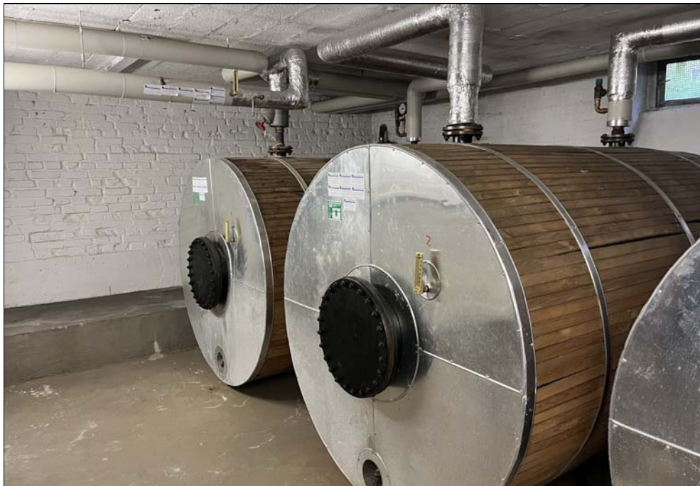
Haustechnik (Kellergeschoss Kamminer Straße 29 A)
