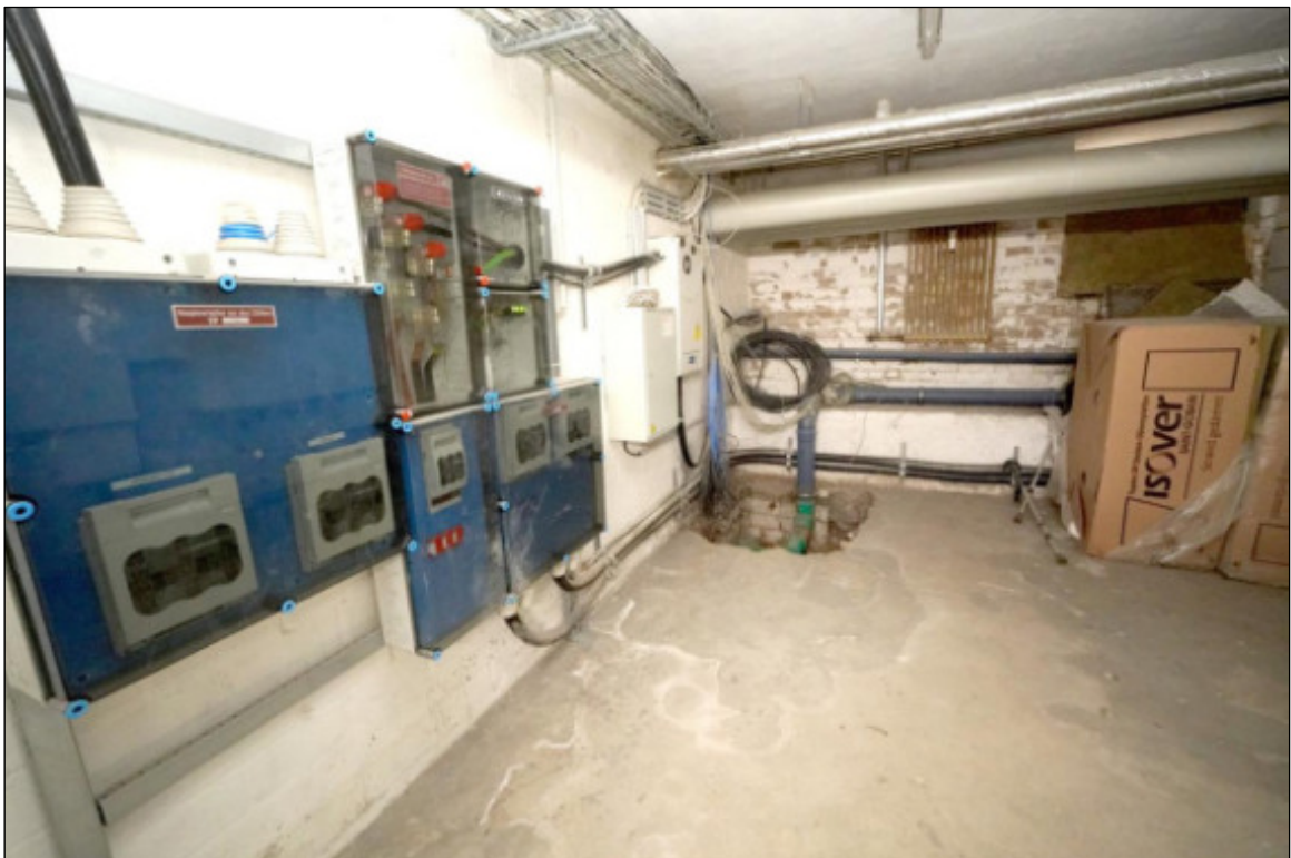
Hausanschlussraum im Vorderhaus
