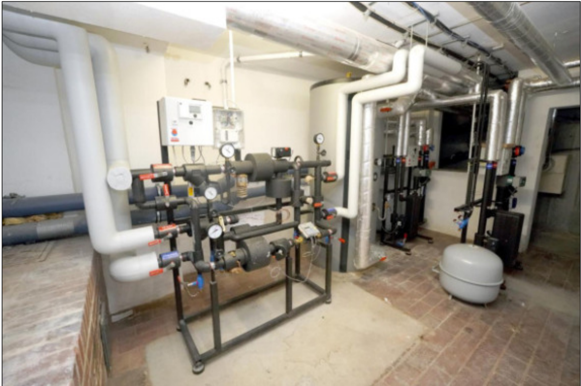
Fernwärmeanschluss im Vorderhaus
