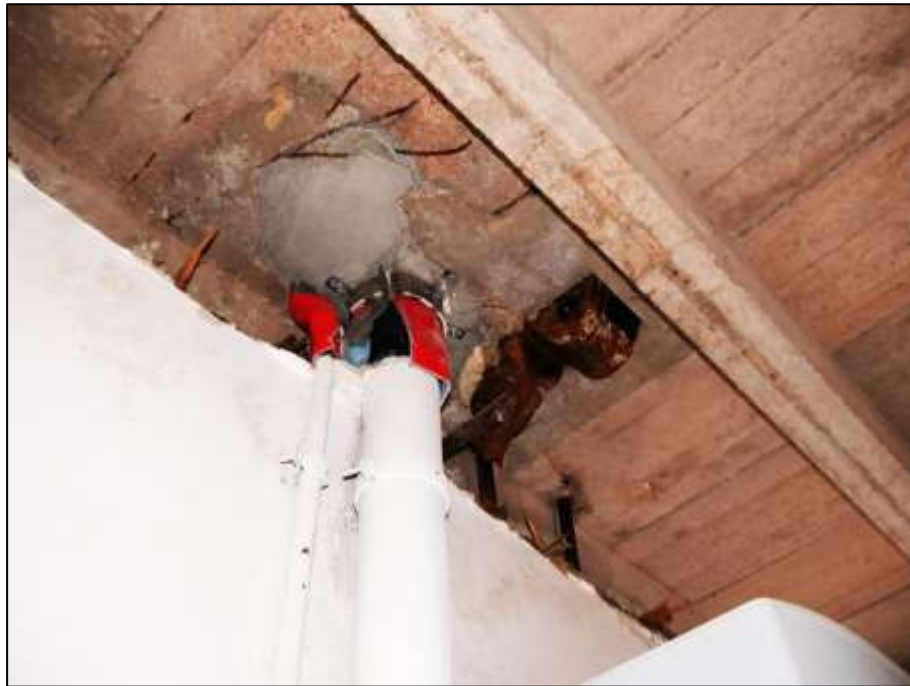
Raumdecke im Badezimmer des Wohnungseigentums Nr. 20 im 3.OG postalisch rechts im Gebäudeteil Hildegardstr. 18
