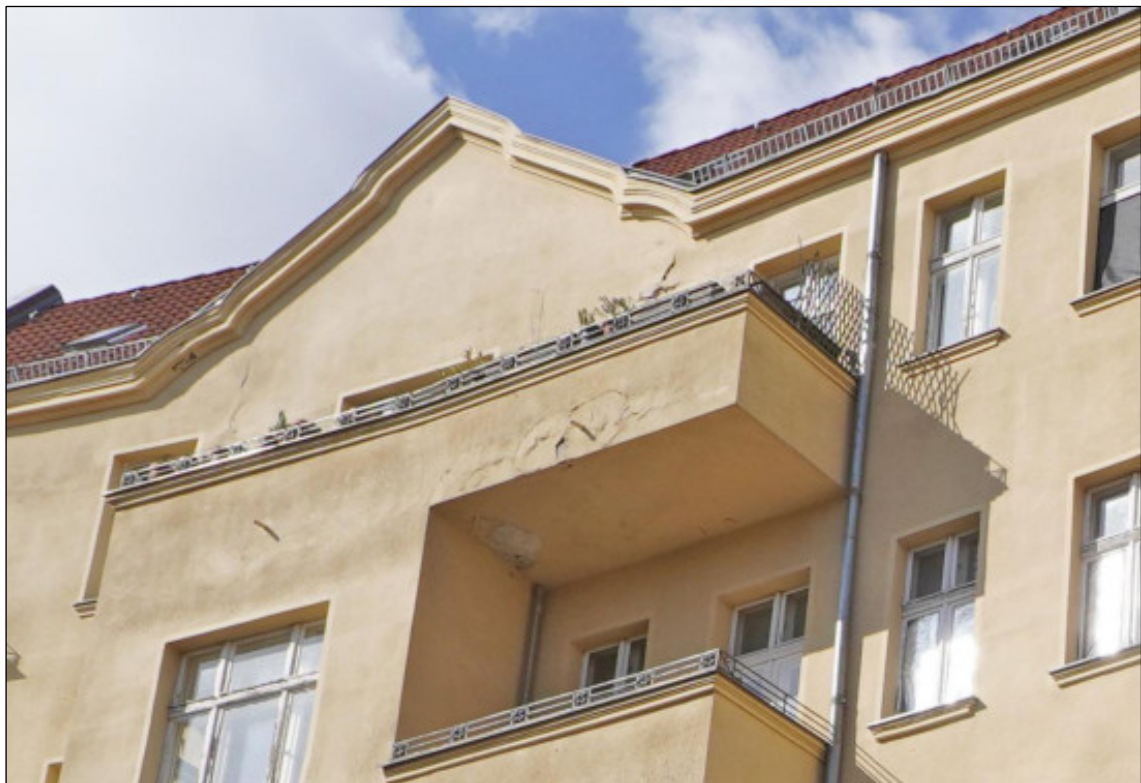
Putzschäden im Fassadenbereich / Balkon
