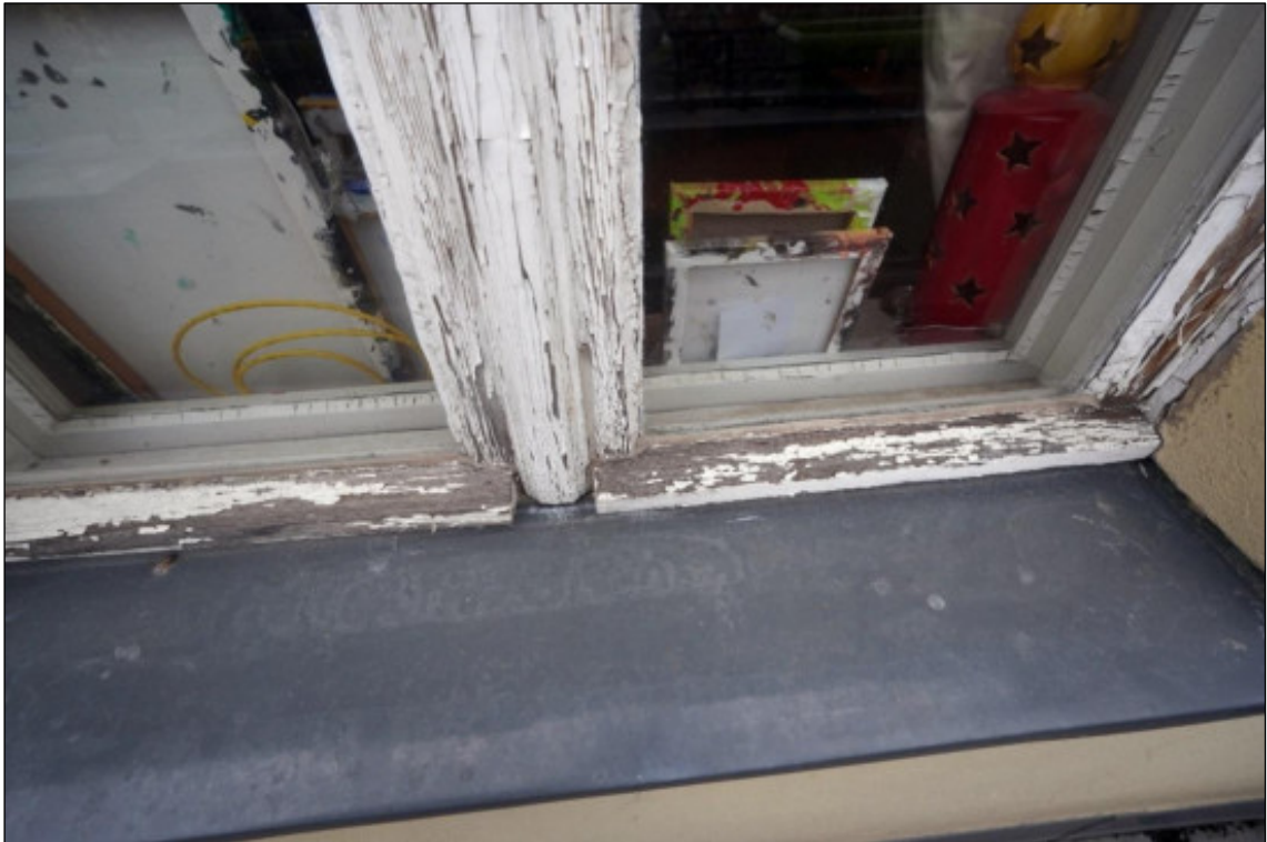
Geschädigte Holzfenster (Aufnahme vom 06.11.2024)
