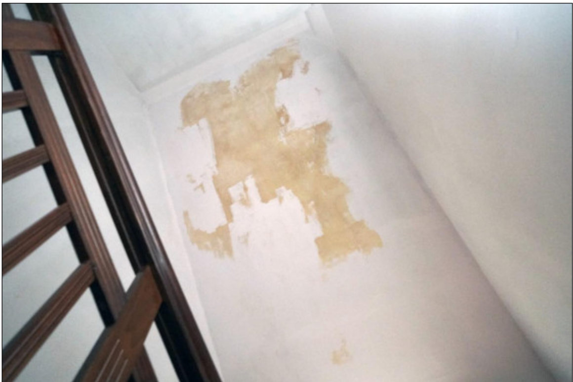
Wasserschaden im Treppenraumkopf (Aufnahme vom 06.11.2024)
