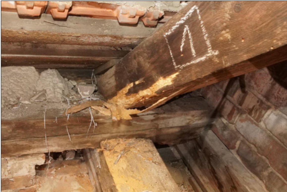
Möglicher Schädlingsbefall im Dachgeschoss (Aufnahme vom 06.11.2024)
