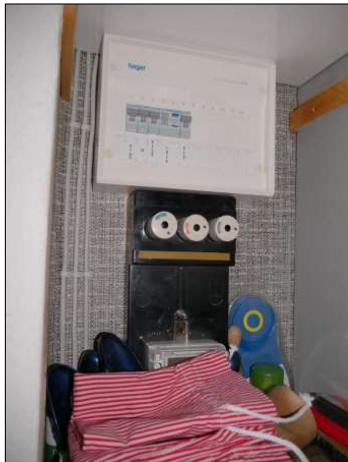
Sicherungstableau im Flur des Wohnungseigentums Nr. 8 im 1.OG postalisch rechts im Gebäudeteil Hildegardstr. 18A
