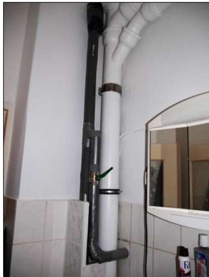
Rohrinstallation im Badezimmer des Wohnungseigentums Nr. 6 im 1.OG postalisch links im Gebäudeteil Hildegardstr. 18A
