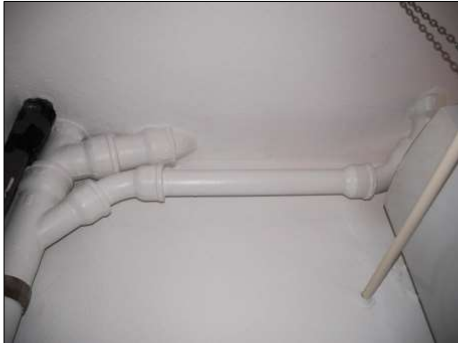
Rohrinstallation unter der Raumdecke im Badezimmer des Wohnungseigentums Nr. 6 im 1.OG postalisch links im Gebäudeteil Hildegardstr. 18A
