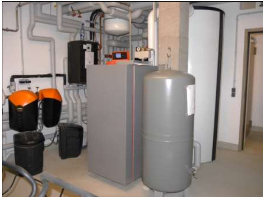
Heizzentrale des Anwesens im Kellergeschoss des Gebäudeteils Koenigsallee 16 J (Haus A)
