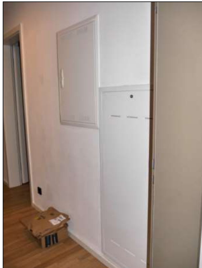
Flur einer Woh- nung mit Fuß- boden-Heiz- kreislaufvertei- lungskasten und Siche- rungsschrank
