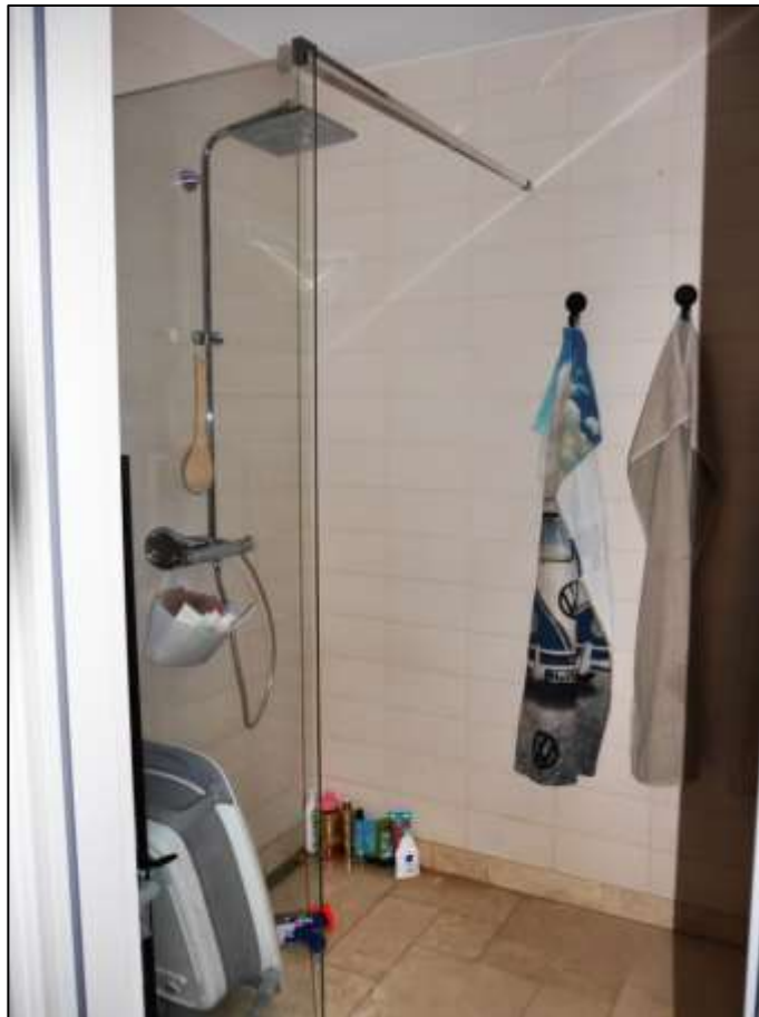
standardtypisches Duschbadezimmer einer Wohnung u.a. mit bodengleichem Duschstand und sogen. Regendusche
