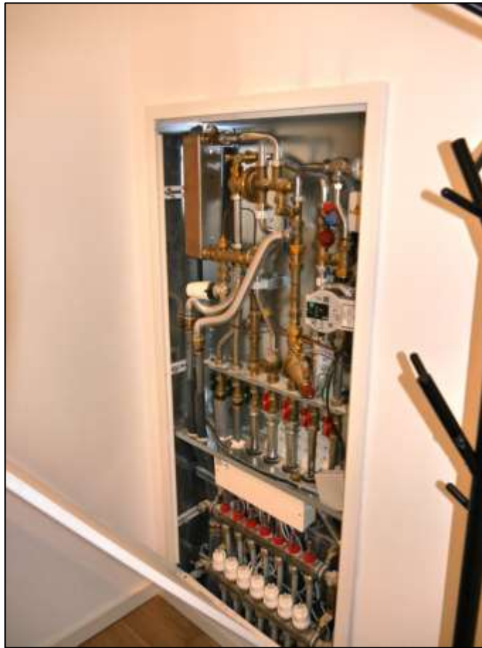
Fußboden- Heizkreislauf- verteilungskas- ten
