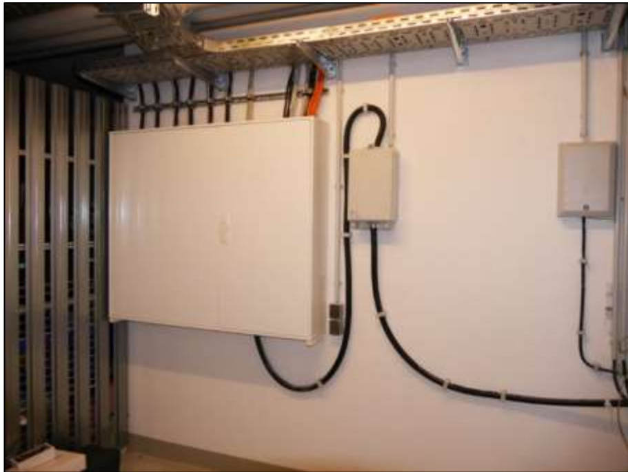
an den Zentralflur im Kellergeschoss des Gebäudeteils Königsallee 16 I anbindender Alu- bzw. Leichtmetall-Lamellenverschlag als Stromzählerraum
