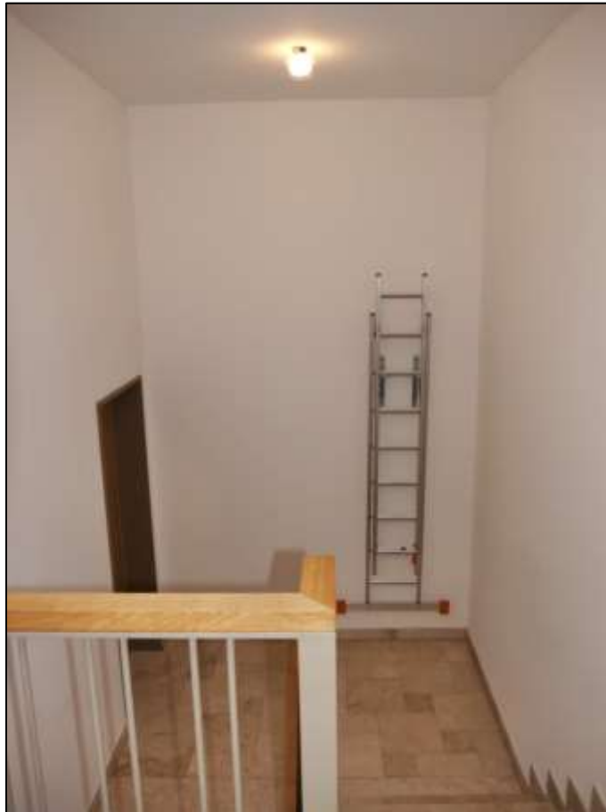
Treppenhaukopf des Gebäudeteils Koenigsallee 16 I mit wandverwahr- ter Anstallleiter auf dem Zwi- schengeschoss- podest für die RWA-Anlage mit Lichtkuppel u.a. als Dachausstieg
