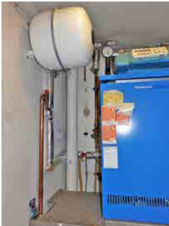
Heizung für die Einheit
