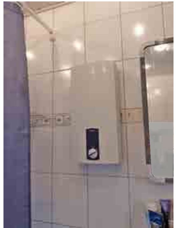
Bad mit E-Durchlauferhitzer
