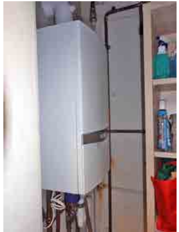
Heizung für die Einheit
