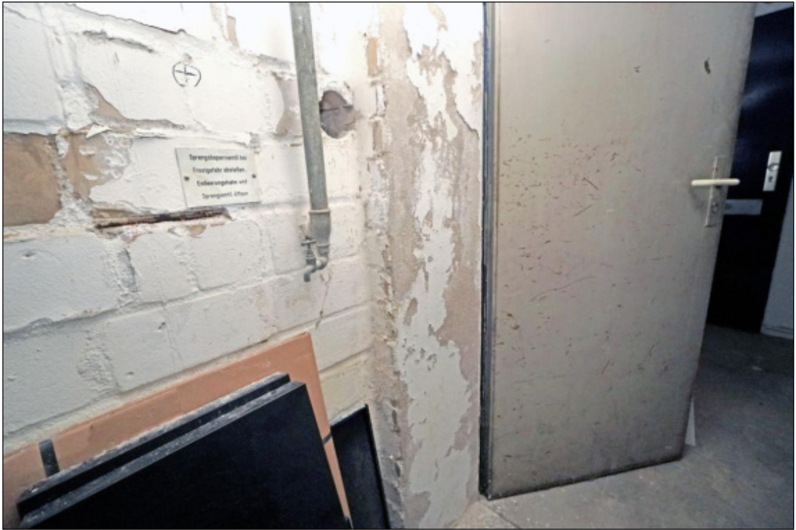
Kellergeschoss, Nässe im Lagerraum des Bewertungsobjekts
