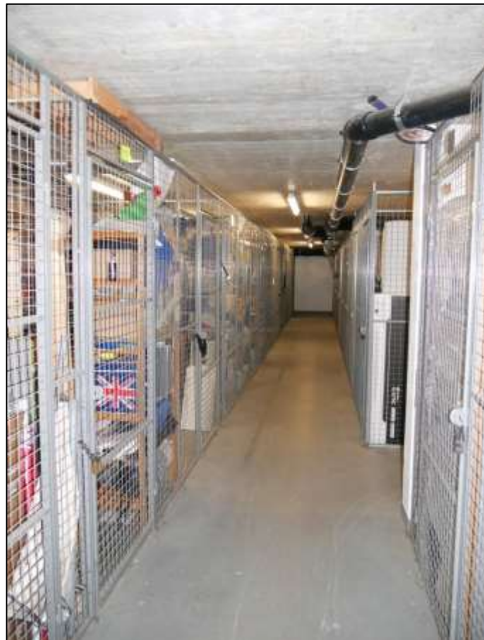
Abstellkellerbereich auf dem Nachbargrundstück Mollwitzstr. 11, 12 (Flurstück 1235) im Bereich der Gebäudeteile Mollwitzstraße 12 und Sophie-Charlotten-Str. 115B
