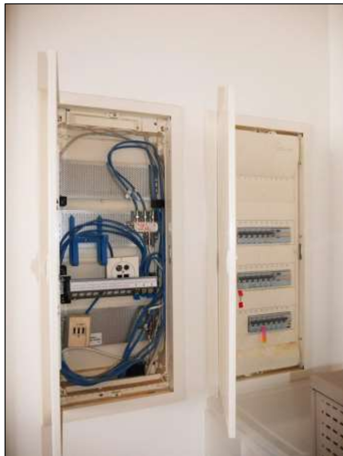
Sicherungstabelle und Multi- media-Verteiler im Flur des Wohnungseigentums Nr. B.5.1 im 5.OG (DG) des Gebäudeteils So- phie-Charlot- ten-Straße 115
