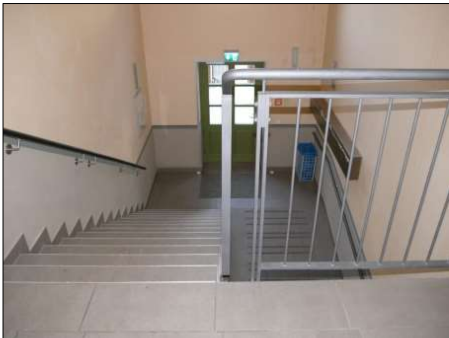
Blick aus dem 1.OG der Hauseingangshalle im Gebäudeteil Sophie-Charlotten-Str. 115 auf die aus dem Hauseingangsbereich aufgehende Treppe
