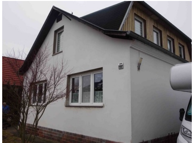
Abb. 9 EFH - Fassade, Klinkersockel, Gaube
