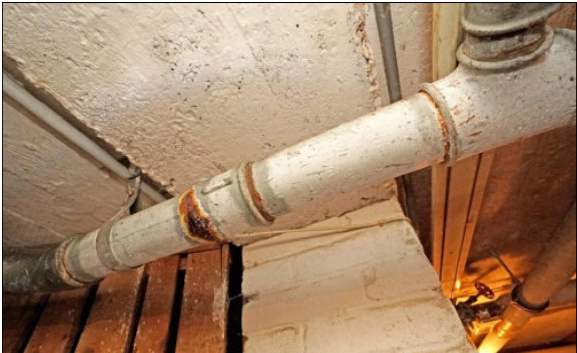
Neubau, Kellergeschoss, Schäden am Leitungssystem
