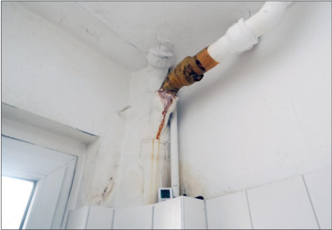
Neubau, Badezimmer, Schäden am Leitungssystem
