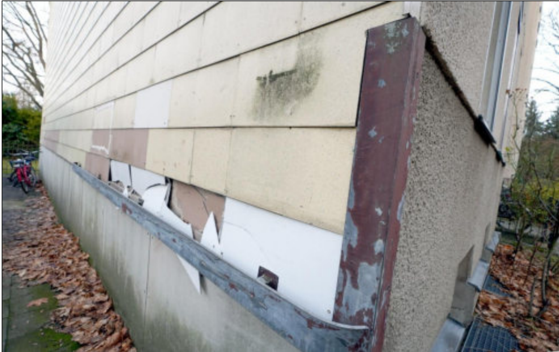
Altbau, Schäden an der Fassadenverkleidung, möglicherweise asbesthaltig
