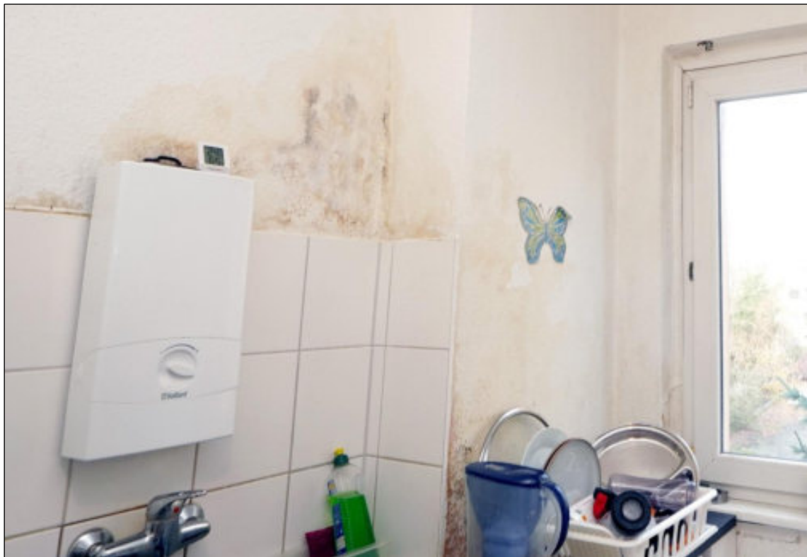
Neubau, Küche mit Schimmelbefall
