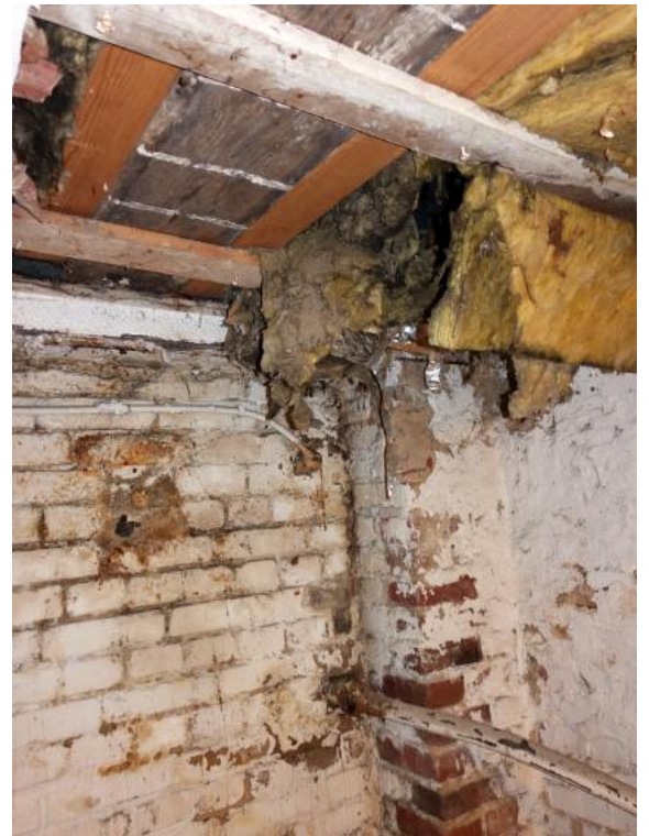
Detail, Schaden an der Decke
