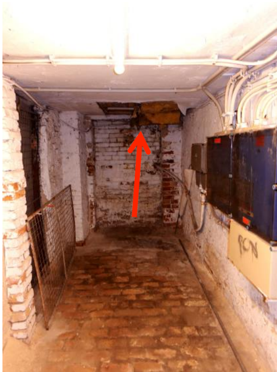
Keller, Stromverteilung, Schaden an der Decke
