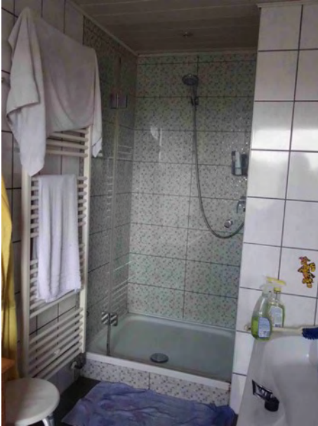
Abb. 52 separate Dusche im Wannenbad Wohnung 2 (DG)
