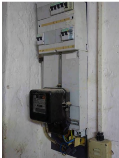
Abb. 20 Sicherungskasten im KG
