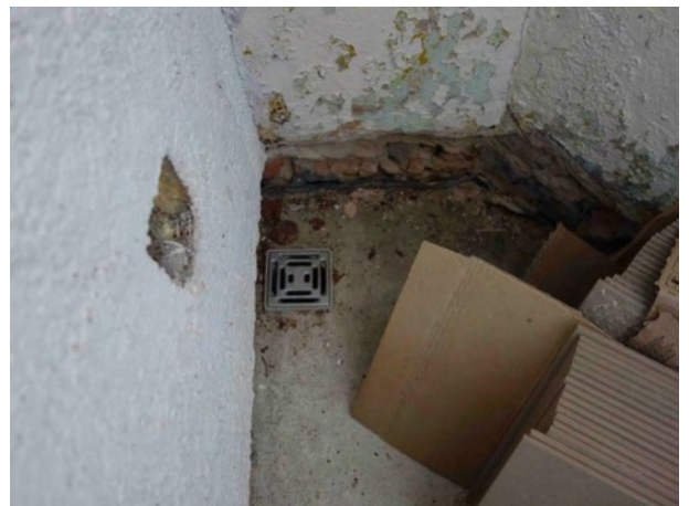
Abb. 37 Balkonabfluss Wohnung 2 (1. OG)
