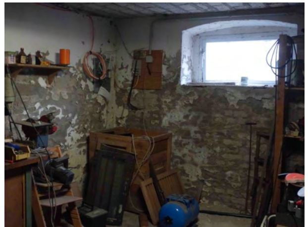
Abb. 19 Feuchtschäden an Kellerwänden
