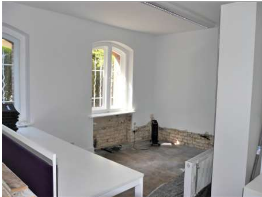
Büroraum im Souterrain in der süd-westlichen Gebäudeecke mit Außenwanddurchfeuchtungen bzw. deshalb bereits abgenommenem Putz
